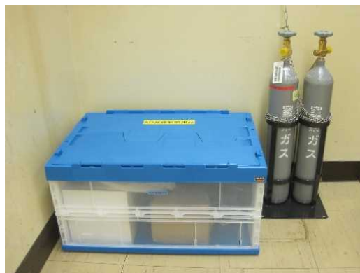
空気作動弁強制操作用の資機材配備(福島第二原子力発電所) (圧縮空気ポンプ, 接続用ホース, 接続部品等)
