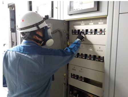
直流電源延命のための負荷カット手順に基づいた操作訓練 (柏崎刈羽原子力発電所)
