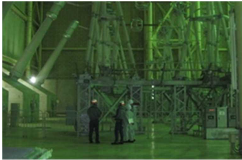
開閉所機器の確認
