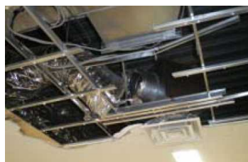
天井材の落下
