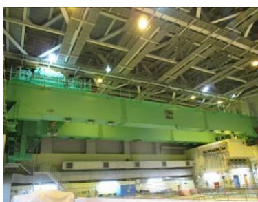
原子炉建屋クレーン
