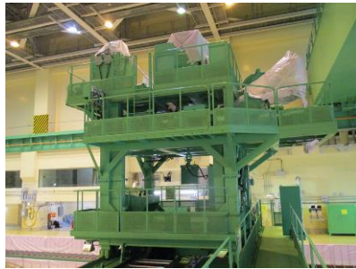
燃料取替機（トロリ）外観
