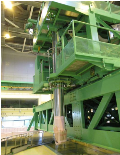
燃料取替機（トロリ）外観
