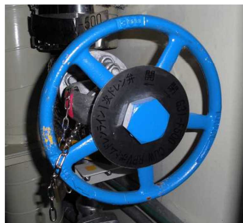
KK7原子炉圧力容器ドレン弁
