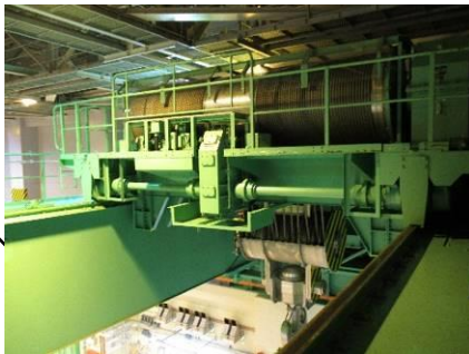
原子炉建屋クレーン外観
