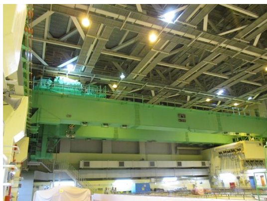
原子炉建屋クレーン外観
