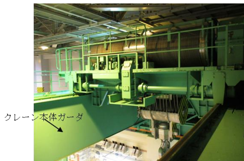
原子炉建屋クレーン外観
