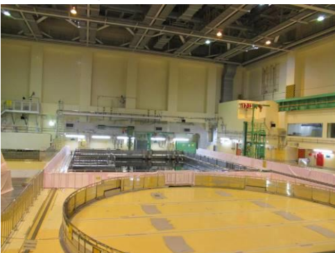
原子炉建屋オペレーティングフロアの床面上設備
