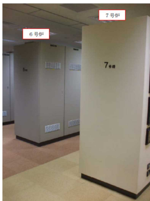
第 2.4.3-2 図 制御盤（裏盤）の色別管理
