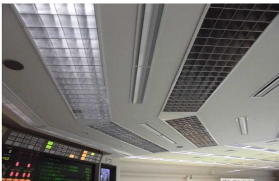
中央制御室照明
