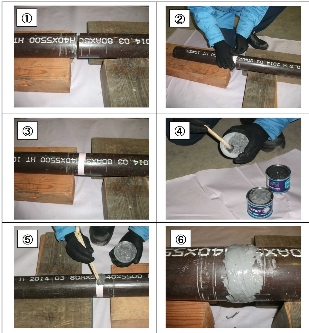
図 2.1.2-4 ベロメタル補修の例示
