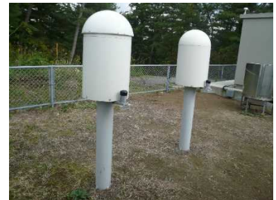
モニタリングポスト設置状況
