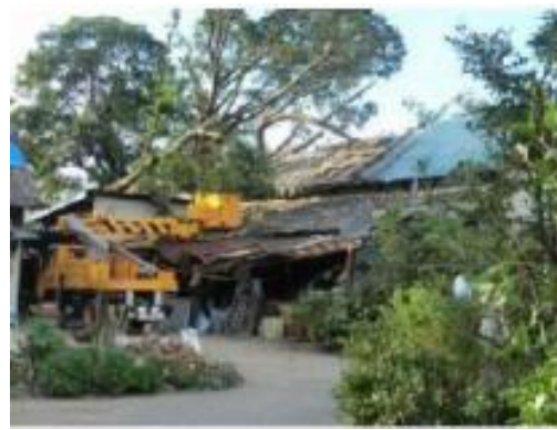
樹木の倒壊による小屋組の被害
