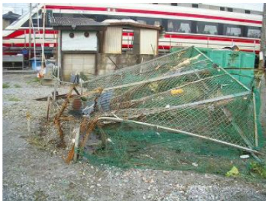
フェンスの著しい変形
