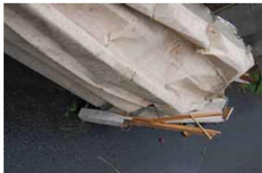
飛散した折板屋根の状況
