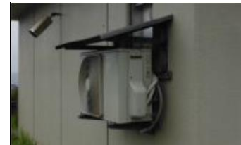
⑥-27 空調室外機
