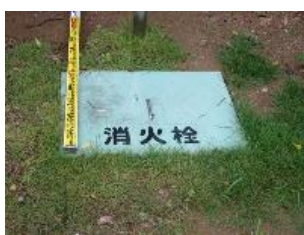
③-10 消火栓蓋
