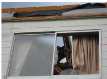
窓ガラスの損壊
