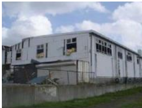
窓ガラスの破損
