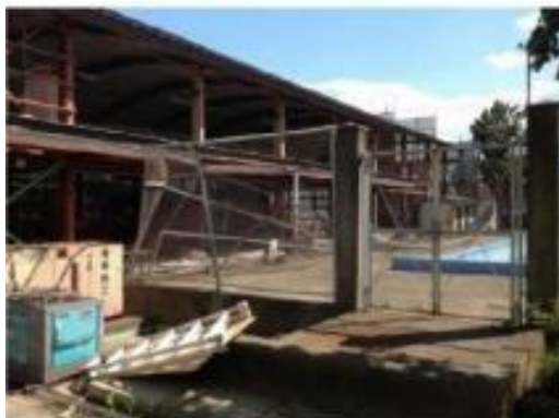
フェンスの被害（工事中の建築物）
