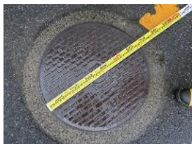
④-1 マンホール蓋
