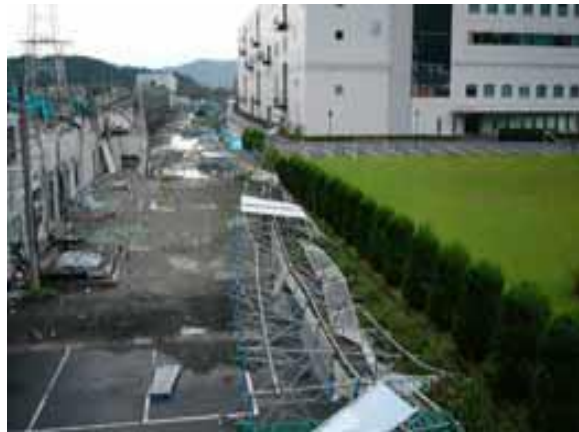
仮設足場の倒壊
