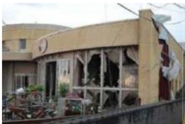
店舗の窓ガラスの被害状況
