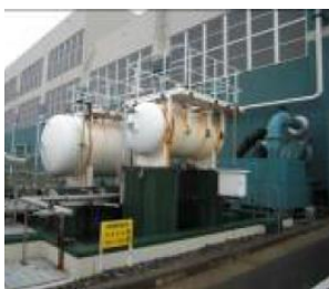
①-31 鋼製タンク
