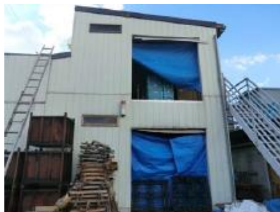
シャッターの被害
