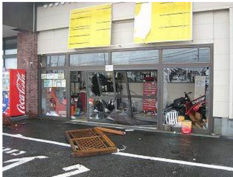
エントランスのガラス破損
