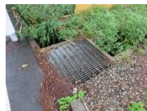
⑤-6 グレーチング
