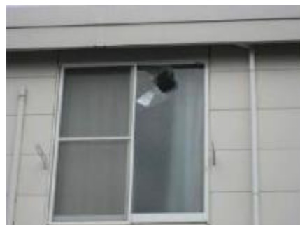
窓ガラスの飛来物衝突痕
