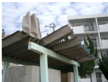
屋外トイレ屋根の損傷
