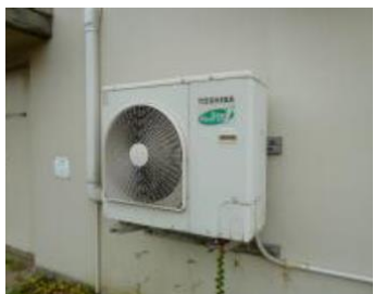
⑦-4 空調室外機
