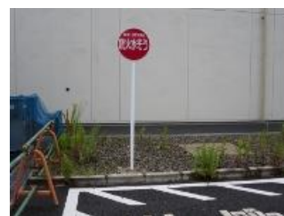
⑤-12 防火標識
