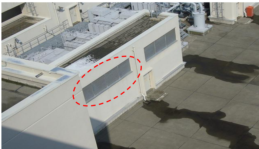
図6-3 中央制御室換気空調系の外気取入口
