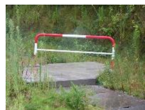
③-9 鋼製フェンス
