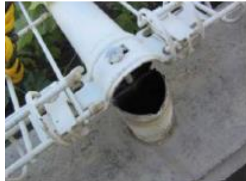
支柱部の破断
