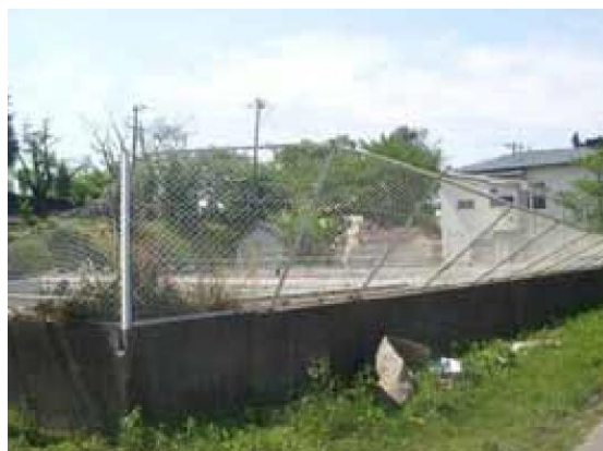
フェンスの被害状況
