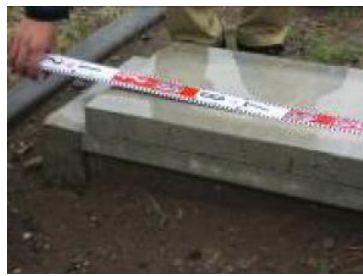
①-5 送水用配管蓋
