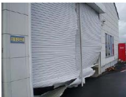
シャッターの破損
