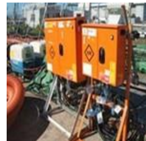
①-6 仮設分電盤
