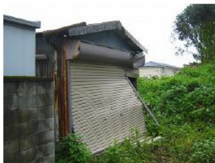
シャッターの外れ
