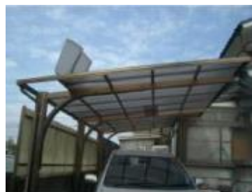
カーボード屋根の破損
