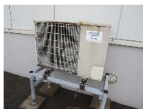
④-14 空調室外機
