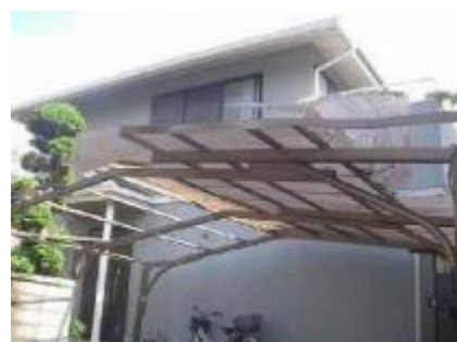
カーボードの被害
