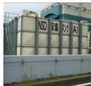
①-24 FRP タンク (FRP=繊維強化プラスチック)
