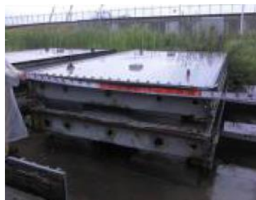
①-23 鋼製架台
