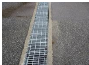
⑤-8 グレーチング
