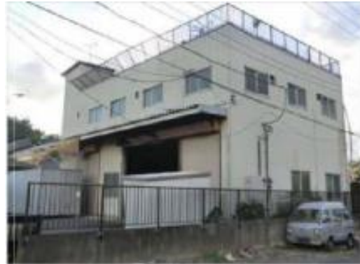
屋上フェンスの被害
