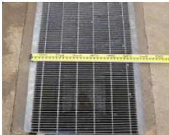
⑦-1 グレーチング
