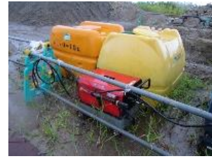
③-18 高圧洗浄機, 水タンク
