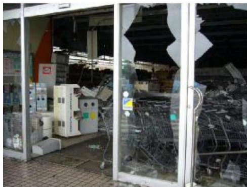
エントランスの窓ガラスの破損
