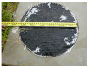
⑦-2 マンホール蓋
