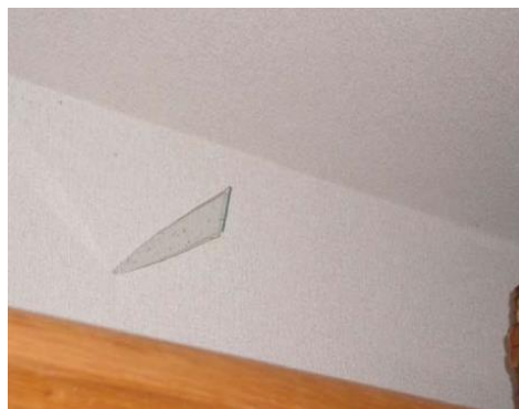
破損した窓ガラス片の屋内壁面への突き刺さり
