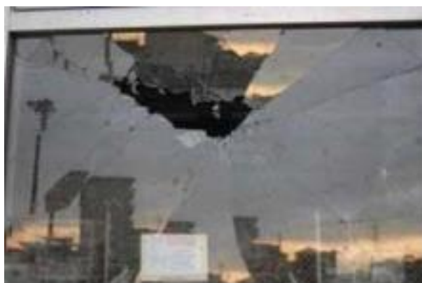
ガラスへの飛来物の衝突痕
