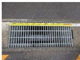
④-2 グレーチング
