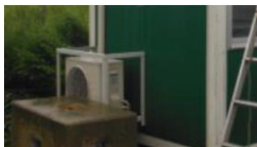
⑥-13 空調室外機
