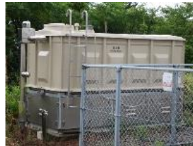
④-20 FRP タンク (FRP=繊維強化プラスチック)
