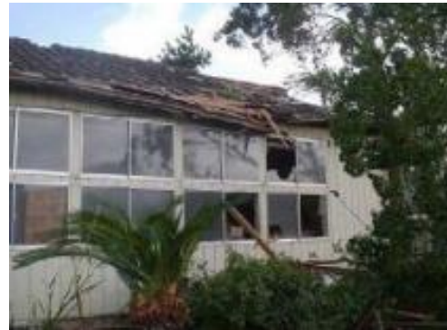
倉庫の窓ガラスと屋根の被害状況
