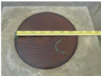
⑦-22 マンホール蓋
