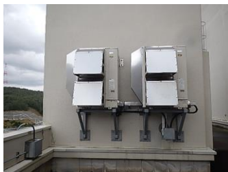
①-13 空調室外機
