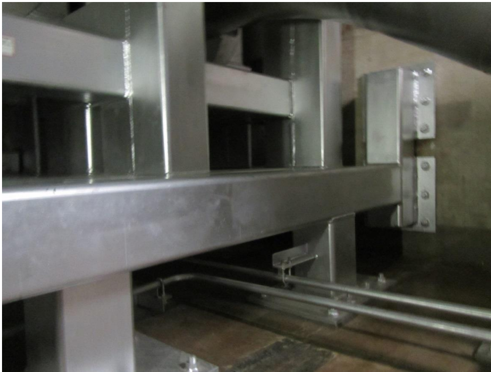
RCW (A) 配管サポート 外観
