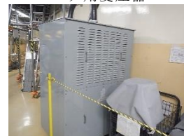
ヒータ用変圧器
