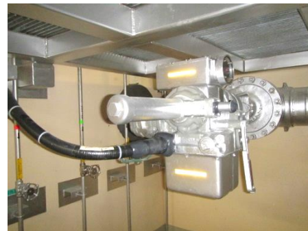
電動弁及び可とう電線管
