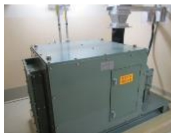
電動機及び可とう電線管
