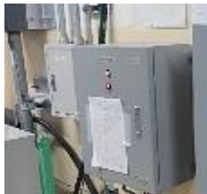
接続箱、作業用電源箱
