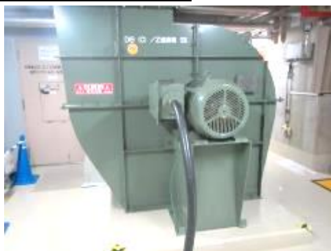
電動機及び可とう電線管
