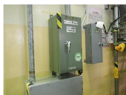
作業用電源箱
