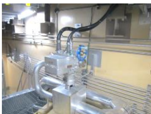
電動弁及び可とう電線管
