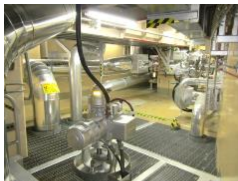
電動弁及び可とう電線管
