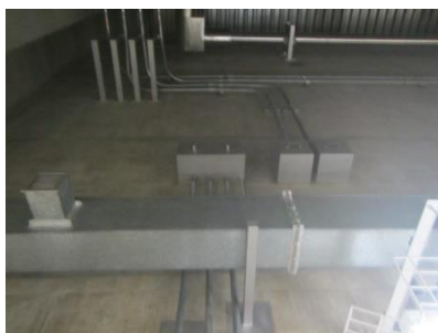
空調ダクト及び可とう電線管
