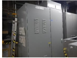
原子炉系多重伝送現場盤
