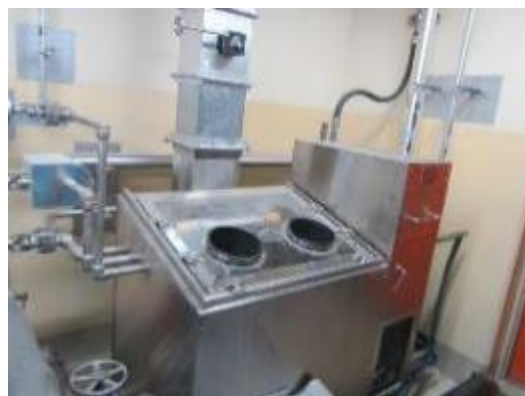
除染シンク及び可とう電線管
