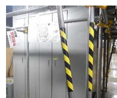
原子炉系多重伝送現場盤
