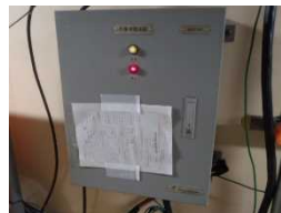
作業用電源箱
