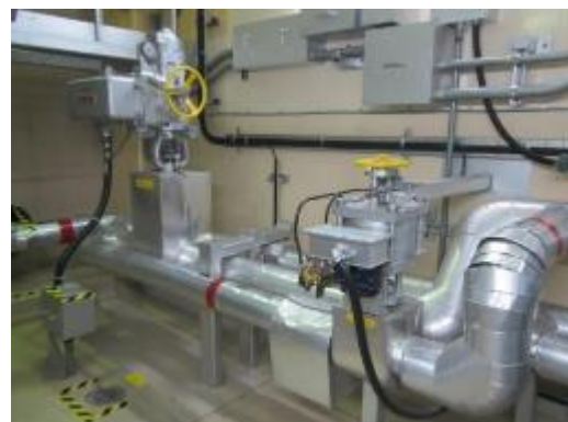
電動弁及び可とう電線管
