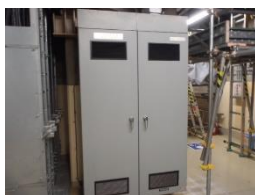
RIP取扱装置現場伝送盤
