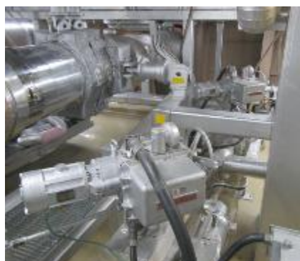
電動弁及び可とう電線管
