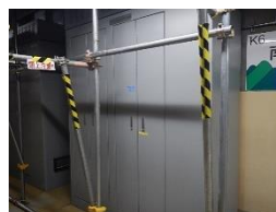
原子炉系多重伝送現場盤
