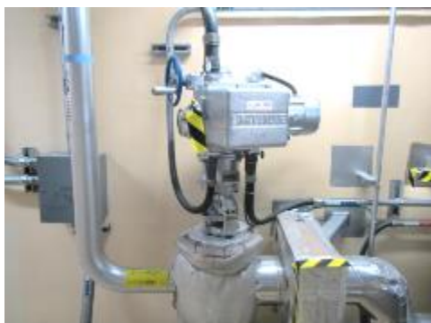
電動弁及び可とう電線管
