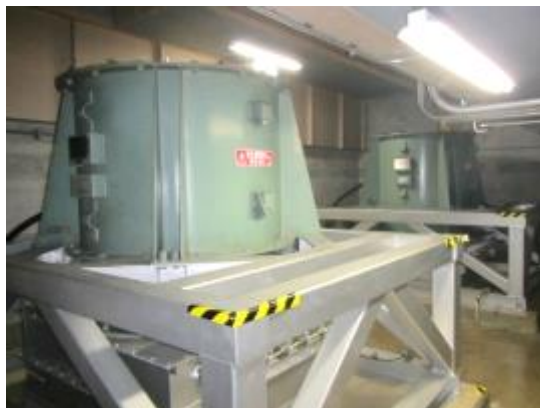
非常用送風機
