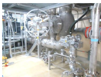
電動弁及び可とう電線管
