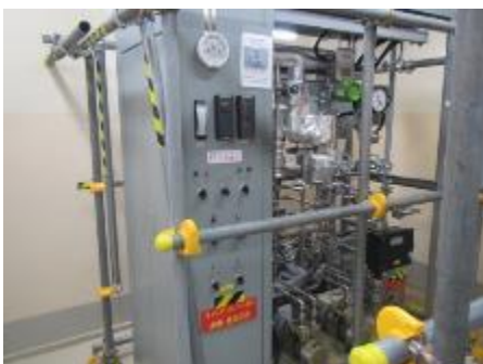
計装ラック及びサンプルポンプ
