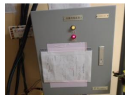
作業用電源箱
