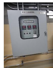
窒素ガス加温器盤
