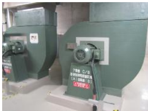
送風機、電動機及び可とう電線管
