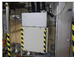
電気ペネトレーション
