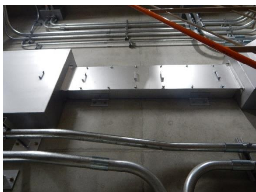
密閉型ダクト及び電線管
