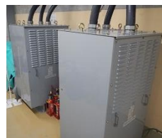
照明用変圧器
