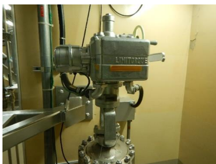
電動弁及び可とう電線管
