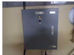
作業用電源箱
