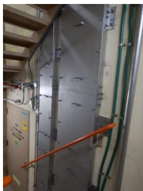
密閉型ダクト及び電線管
