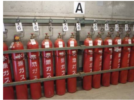
水素ボンベの固縛状況（6号炉）
