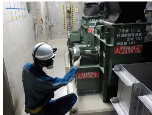
空調機運転状態確認
