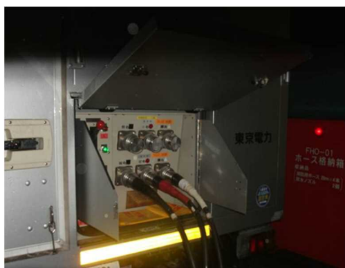
電源車のケーブル接続
