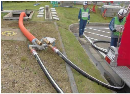
ホースと可搬型代替注水ポンプ吸管との接続 (防火水槽周辺)
