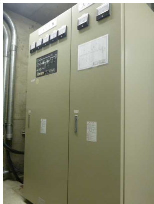
(無停電電源装置の写真)
