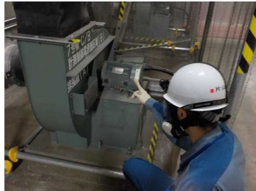
空調機運転状態確認
