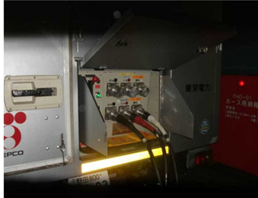
電源車のケーブル接続箇所
