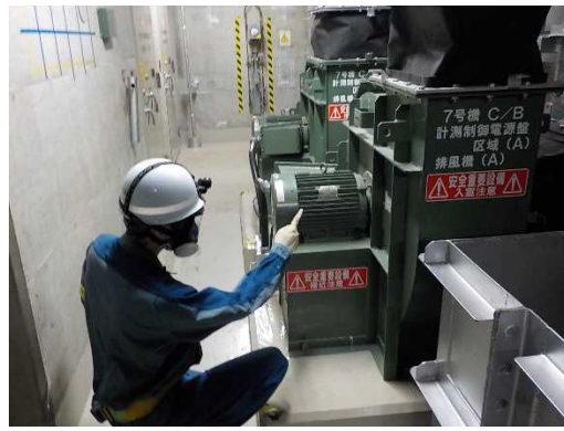
空調機運転状態確認
