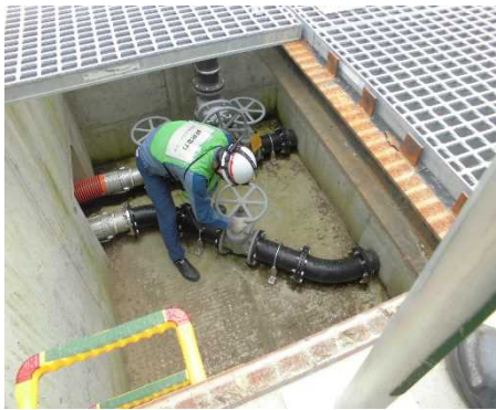
ホース接続部 (淡水貯水池周辺)
