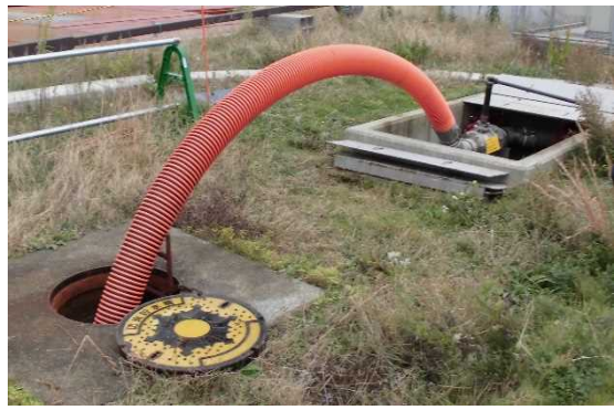
淡水貯水池から防火水槽への補給 (防火水槽周辺)
