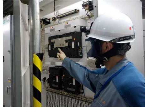
計器電源復旧 (D系)
