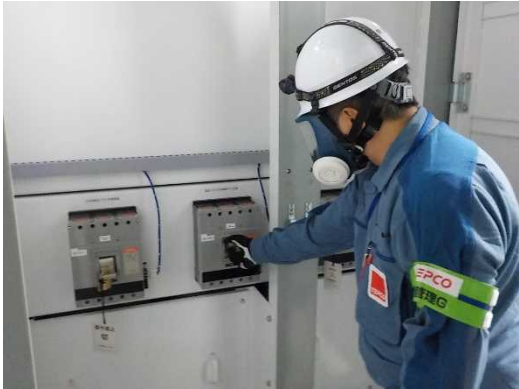
同時投入防止用切替盤
