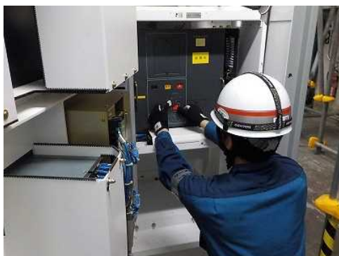
蓄電池遮断器手動開放
