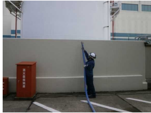
軽油タンクへのホース接続
