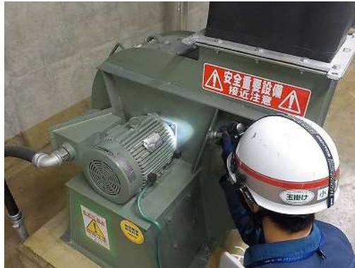
空調機起動状態確認
