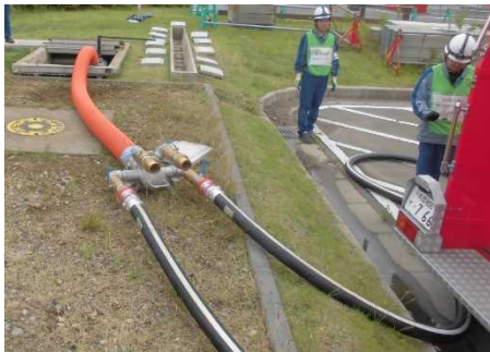
ホースと可搬型代替注水ポンプ吸管 との接続 (防火水槽周辺)
