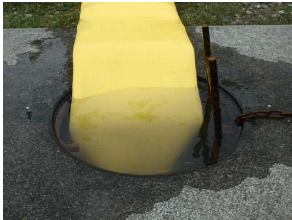
大容量送水車（海水取水用）による防火水槽への海水補給（防火水槽周辺）
