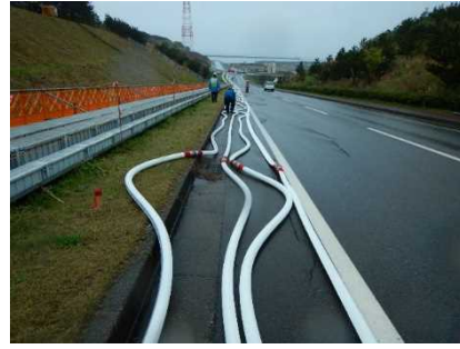
可搬型代替注水ポンプ（取水用） から可搬型代替注水ポンプ（中継 用）までのホース敷設
