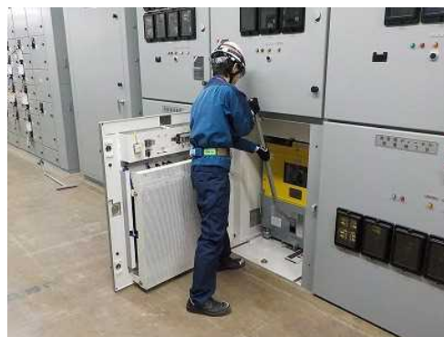
緊急用 M/C 遮断器手動投入
