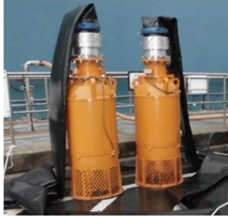
代替原子炉補機冷却海水ポンプ (タービン建屋周辺)
