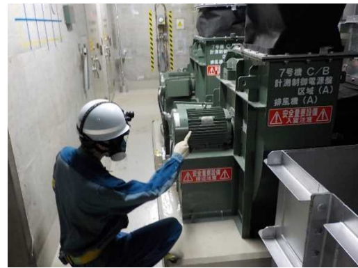
空調機運転状態確認
