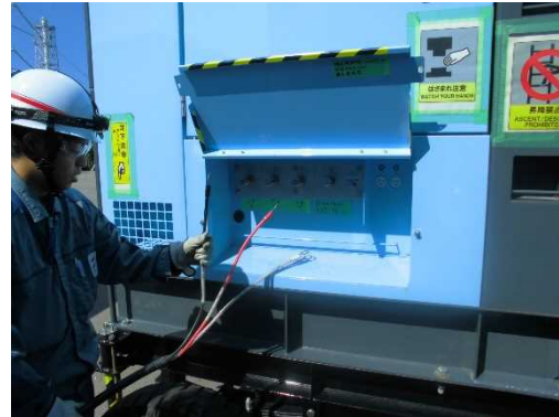
CVケーブル接続 (給水建屋周辺)
