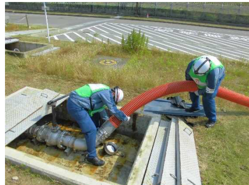
ホースの接続 (防火水槽周辺)
