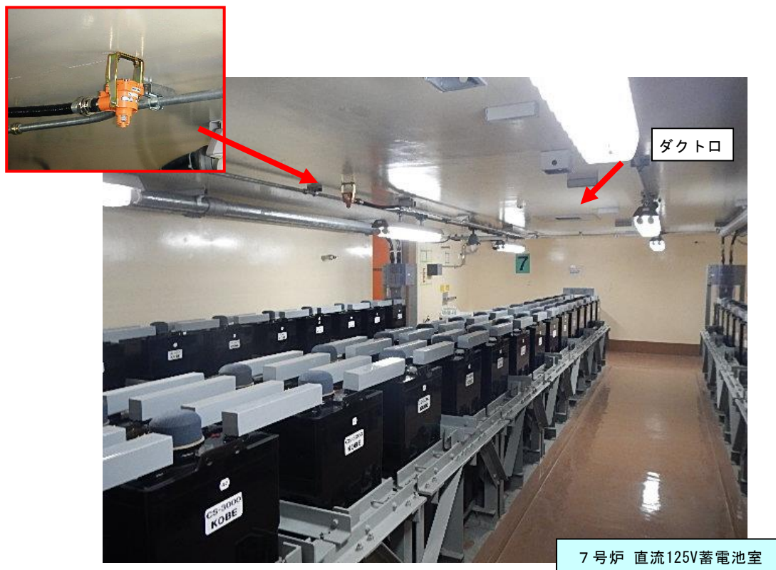
第 1-7 図：蓄電池室内の水素濃度検出器設置状況
