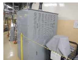
ヒータ用変圧器
