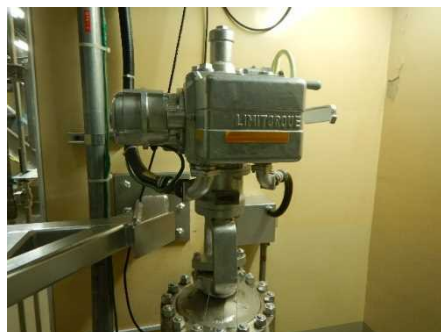
電動弁及び可とう電線管
