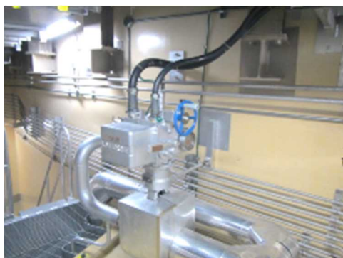
電動弁及び可とう電線管
