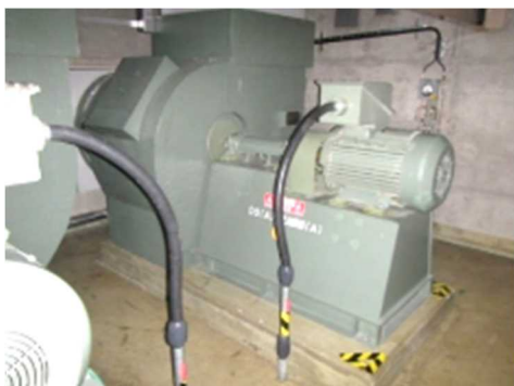
送風機，電動機及び可とう電線管
