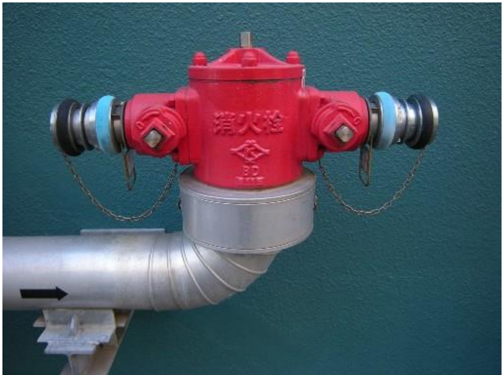
第 1-32 図：不凍式消火栓の設置状況
