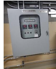
窒素ガス加温器盤
