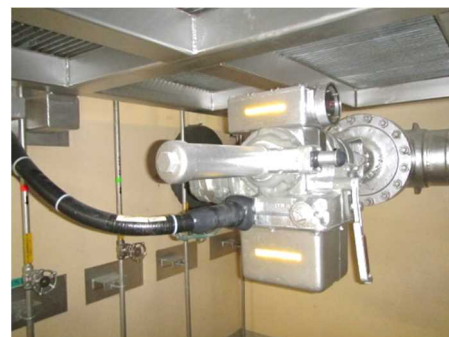
電動弁及び可とう電線管
