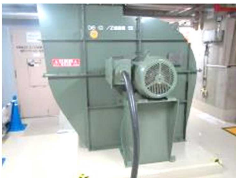
電動機及び可とう電線管
