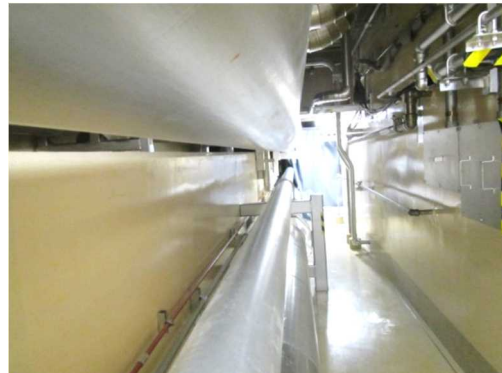
配管及び電線管
