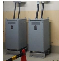
照明用変圧器
