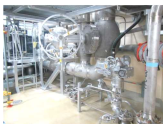
電動弁及び可とう電線管
