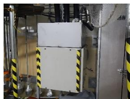
電気ペネトレーション
