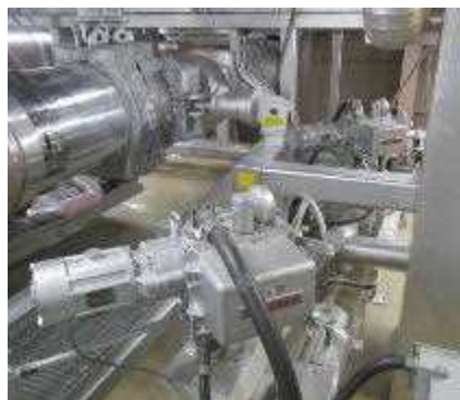
電動弁及び可とう電線管
