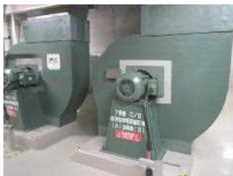
送風機、電動機及び可とう電線管
