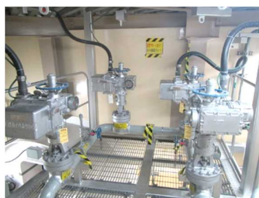
電動弁及び可とう電線管
