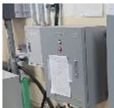
接続箱，作業用電源箱
