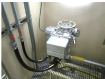
電動弁及び可とう電線管
