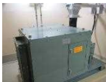
電動機及び可とう電線管
