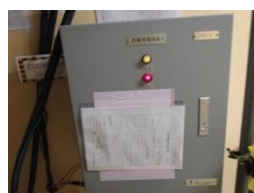
作業用電源箱
