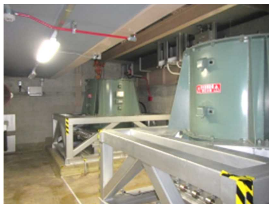
非常用送風機
