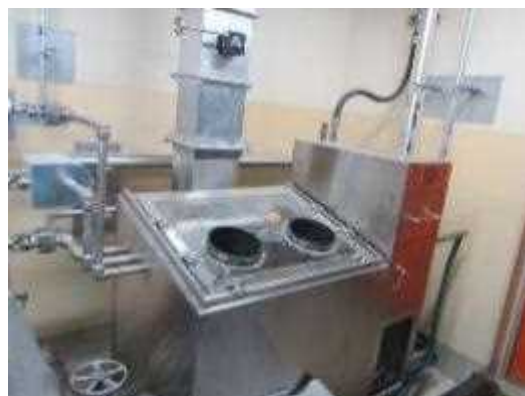
除染シンク及び可とう電線管
