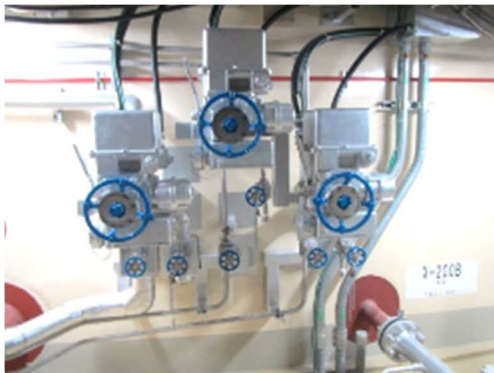
電動弁及び可とう電線管
