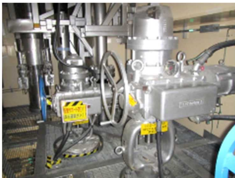
電動弁及び可とう電線管
