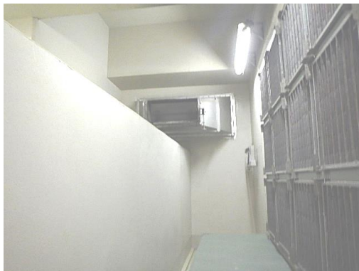
非常用ディーゼル発電機電気品区域 非常用給気処理装置室
