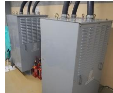
照明用変圧器
