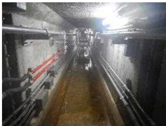
配管及び電線管
