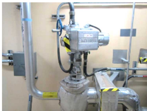
電動弁及び可とう電線管
