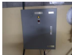
作業用電源箱
