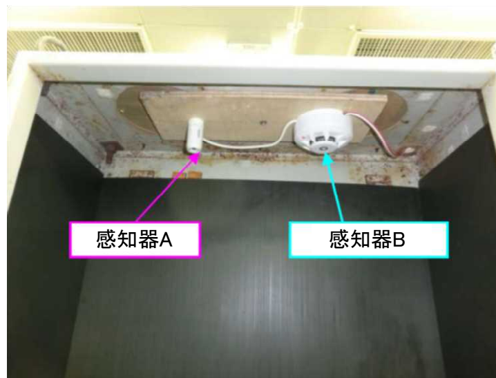
第3図 模擬盤天井面への感知器設置状況
