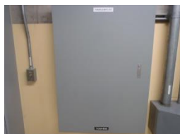
通信設備用分岐箱
