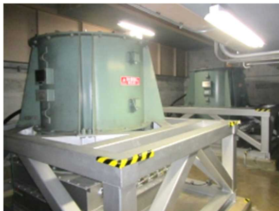
非常用送風機
