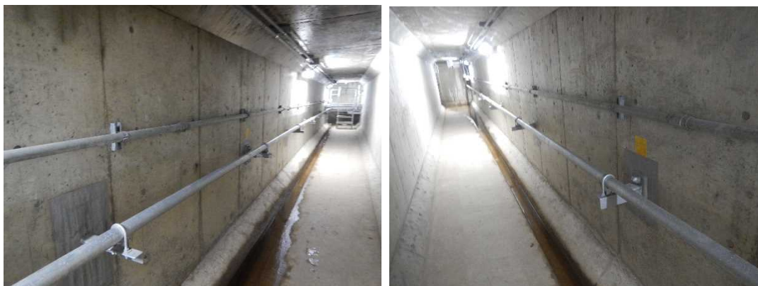
配管及び電線管
