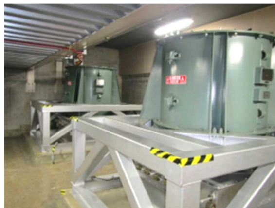
非常用送風機
