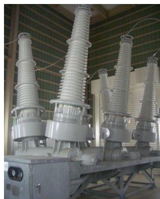
ガス遮断器（154kV） 第2.2.4-9図 開閉所設備外観
