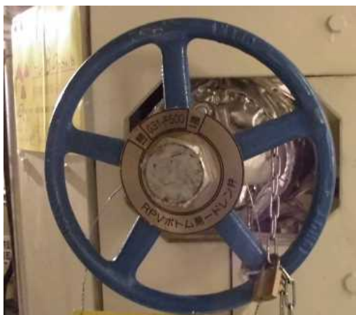
KK6原子炉圧力容器ドレン弁
