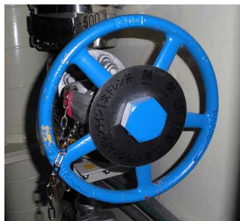
KK7原子炉圧力容器ドレン弁
