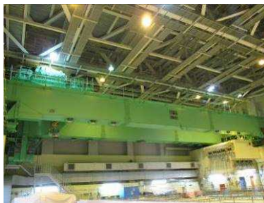
原子炉建屋クレーン
