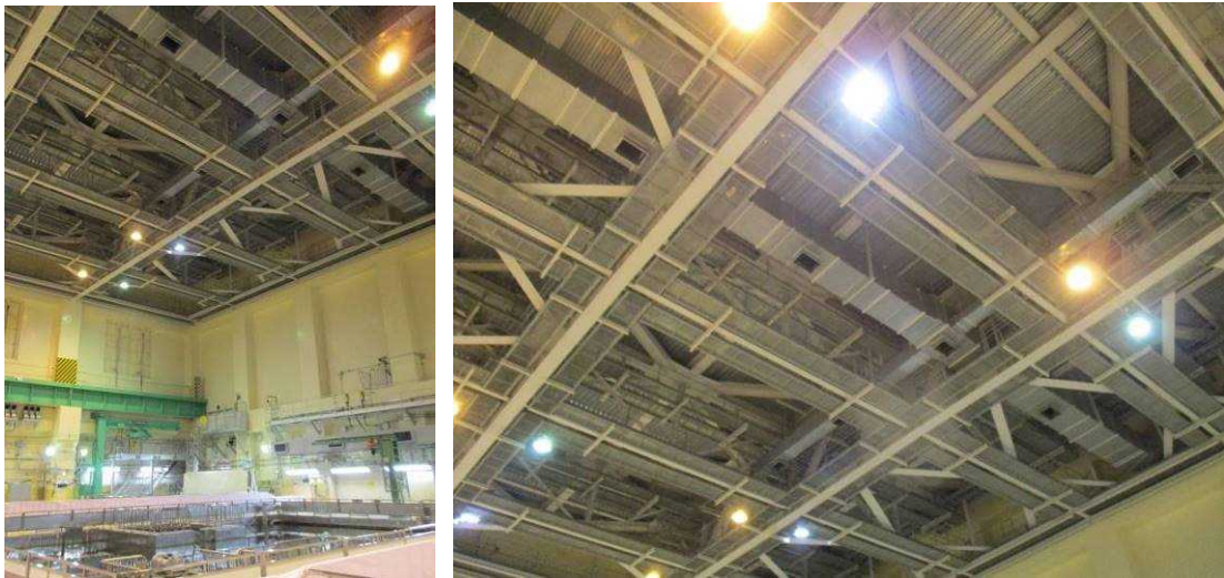
第1図 使用済燃料プール上部のダクト 設置状況（7号炉）
