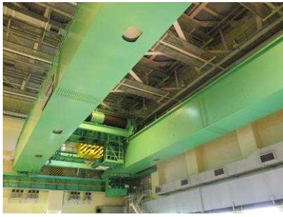
原子炉建屋クレーン外観
