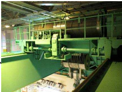
原子炉建屋クレーン外観
