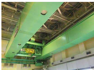
原子炉建屋クレーン
