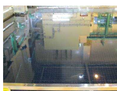
④使用済燃料プール内ラック
