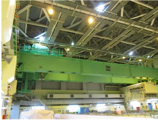
原子炉建屋クレーン外観
