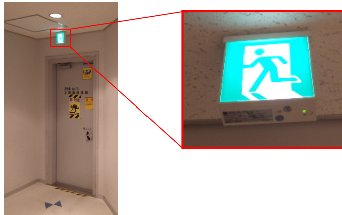
避難口誘導灯
