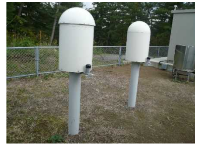
モニタリングポスト設置状況
