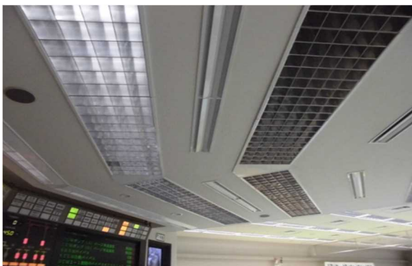
中央制御室照明
