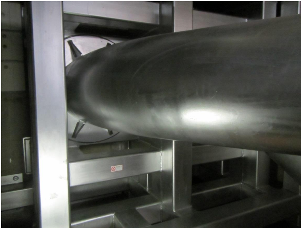
RCW (A) 配管 外観
