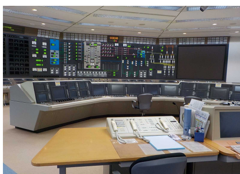
(通常点灯状態)
