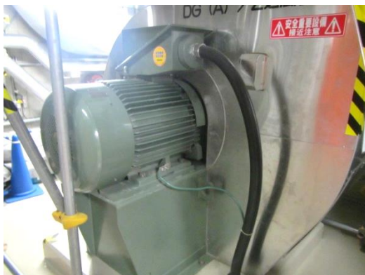
電動機及び可とう電線管
