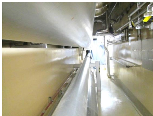
配管及び電線管
