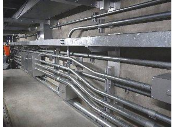
ケーブルトレイ，電線管の例
