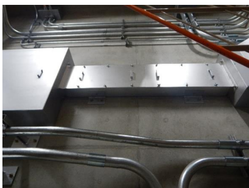
密閉型ダクト及び電線管
