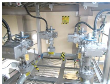
電動弁及び可とう電線管
