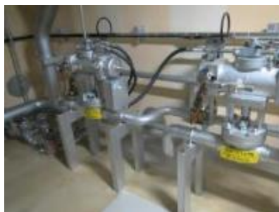
電動弁及び可とう電線管
