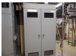
RIP取扱装置現場伝送盤
