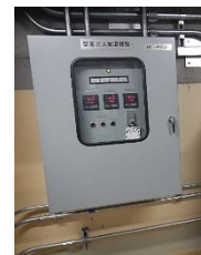
窒素ガス加温器盤
