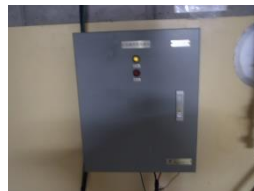
作業用電源箱
