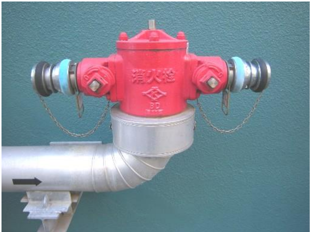
第 41-1-35 図：不凍式消火栓の設置状況
