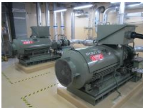
ポンプ及び可とう電線管
