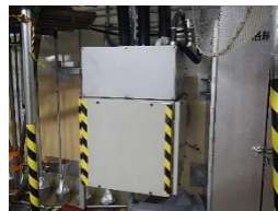
電気ペネトレーション
