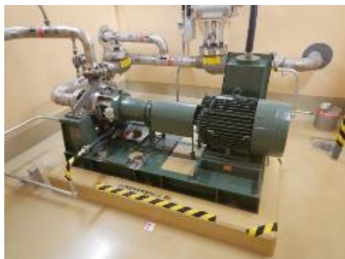
C UW 逆洗水移送ポンプ
