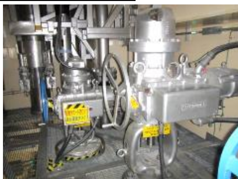
電動弁及び可とう電線管
