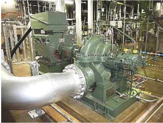
ポンプ，配管，支持構造物の例
