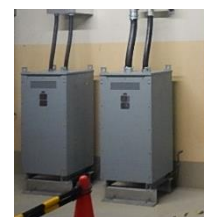
照明用変圧器
