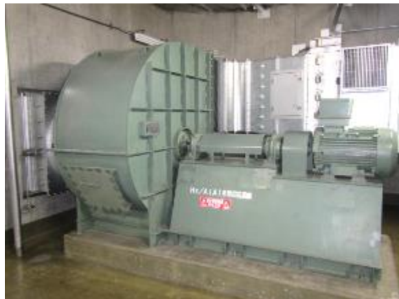
送風機及び電動機
