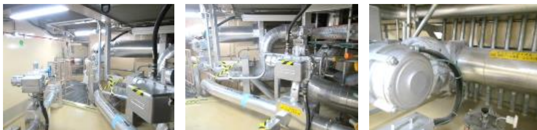
電動弁，空気作動弁及び可とう電線管
