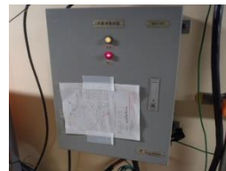
作業用電源箱
