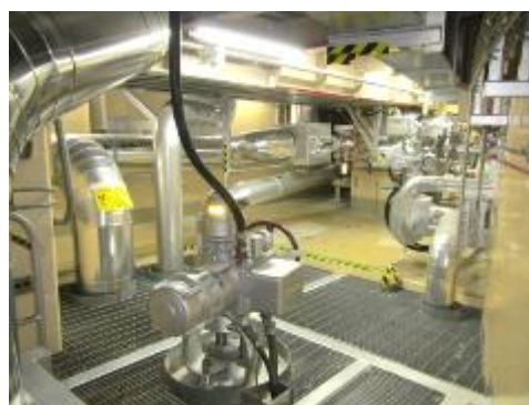
電動弁及び可とう電線管
