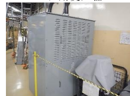
ヒータ用変圧器
