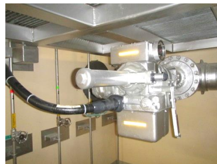
電動弁及び可とう電線管
