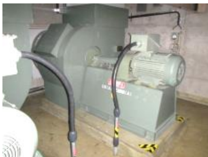
送風機、電動機及び可とう電線管
