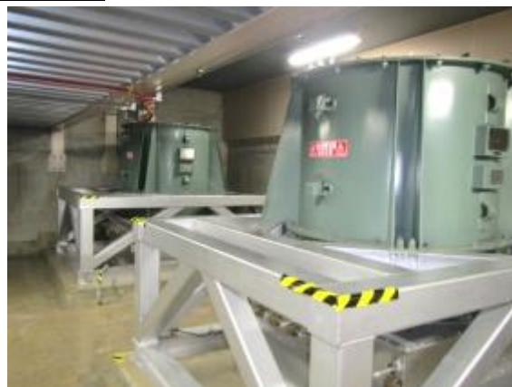
非常用送風機
