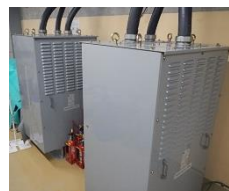
照明用変圧器
