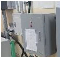
接続箱、作業用電源箱
