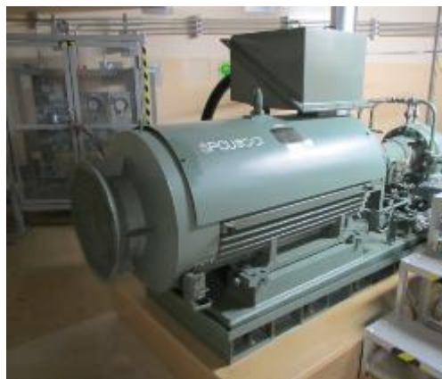
ポンプ及び可とう電線管
