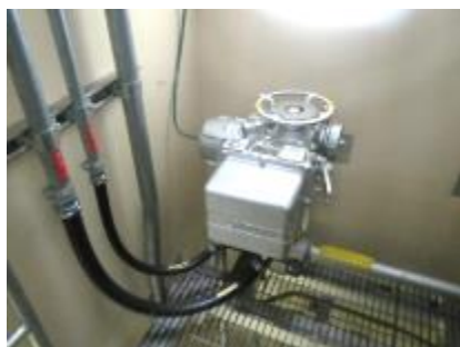
電動弁及び可とう電線管
