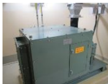
電動機及び可とう電線管
