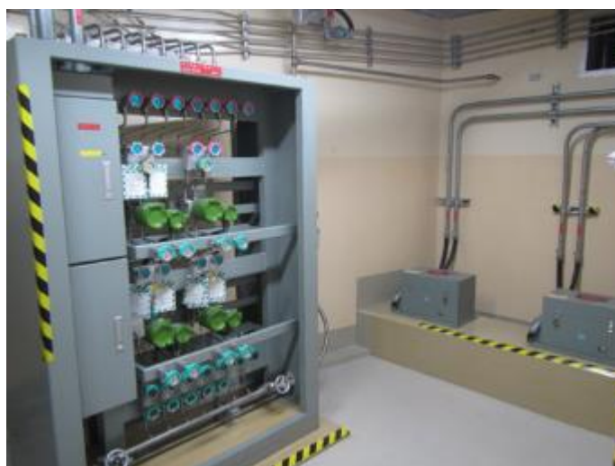
計装ラック及び地震観測装置
