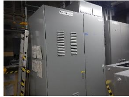
原子炉系多重伝送現場盤
