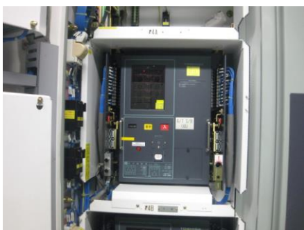
気中遮断器の例 (P/C)
