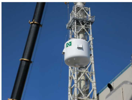
よう素フィルタの搬入・設置 (柏崎刈羽原子力発電所7号炉)
