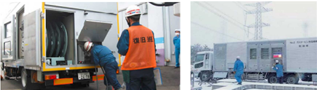
代替交流電源設備（ガスタービン発電機、電源車）の接続訓練
