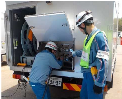
電源車の起動操作訓練
