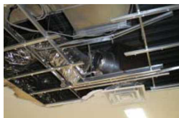
天井材の落下
