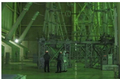
開閉所機器の確認
