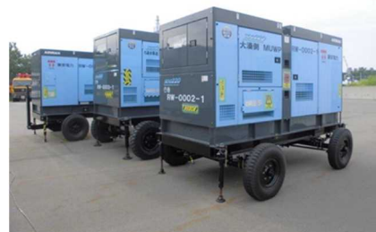
エンジン発電機への車両取り付け （柏崎刈羽原子力発電所）
