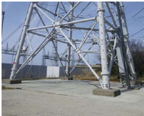
新新潟幹線 No. 1 送電鉄塔
