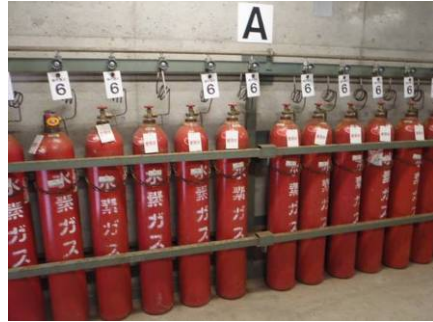
水素ボンベの固縛状況（6号炉）
