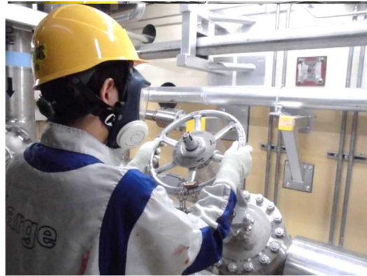
復水移送ポンプ吸込ライン切替え
