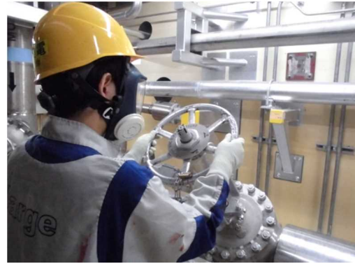
復水移送ポンプ吸込ライン切替え
