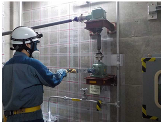
ベント操作（遠隔手動弁操作設備）
