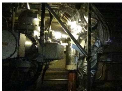
原子炉隔離時冷却系 起動操作
