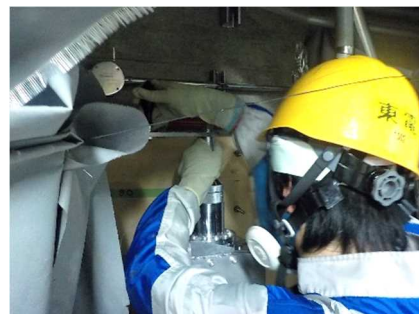
(系統構成) リンク機構の取外し後に、 ハンドルを取り付け、弁操作
