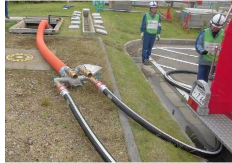
[淡水貯水池を水源とした場合] ホースと可搬型代替注水ポンプ 吸管との接続
