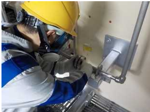
仮設ホース接続
