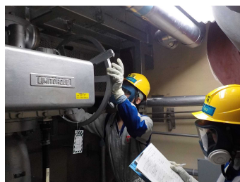
高圧代替注水系 起動操作
