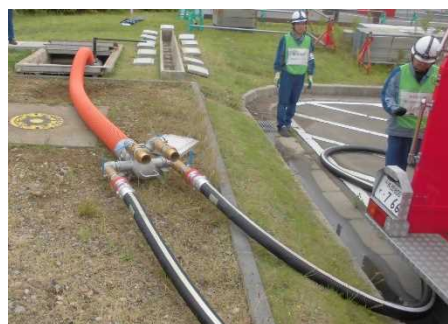
[淡水貯水池を水源とした場合] ホースと可搬型代替注水ポンプ 吸管との接続
