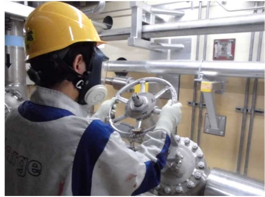
復水移送ポンプ吸込ライン切替え
