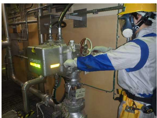
現場での注水操作 (残留熱除去系 (A), (B) 注入配管使用の場合)
