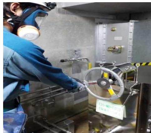
格納容器ベント操作 （遠隔手動弁操作設備）
