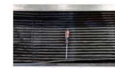
勾配 45° : 隙間あり/ストップパなし 最大損傷長: 850mm
