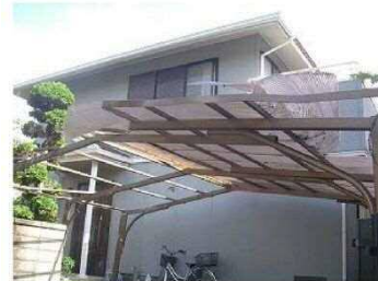
カーポートの被害
