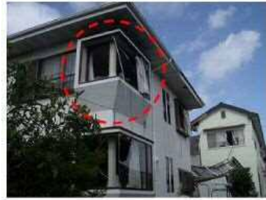
出窓部の窓ガラスの被害
