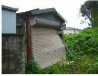
シャッターの外れ
