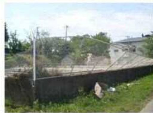
フェンスの被害状況
