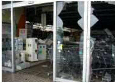
エントランスの窓ガラスの破損
