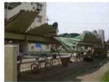
駐車場の折板屋根の著しい変形
