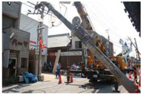
倒れた電柱(復旧作業時)
