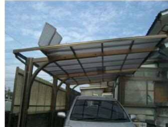
カーポート屋根の破損
