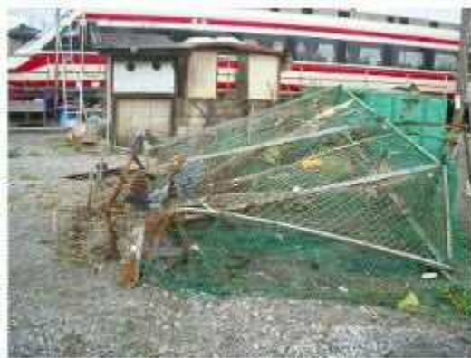
フェンスの著しい変形
