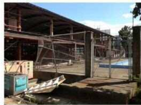
フェンスの被害（工事中の建築物）
