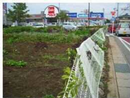
フェンスの変形
