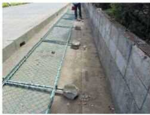
フェンスの倒壊
