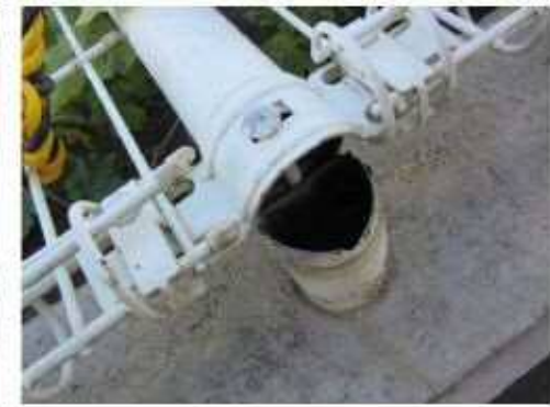
支柱部の破断
