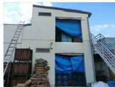
シャッターの被害
