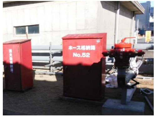
#153 消火設備格納箱
