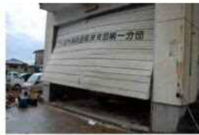
消防団施設のシャッターの被害状況
