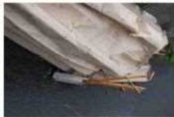
飛散した折板屋根の状況
