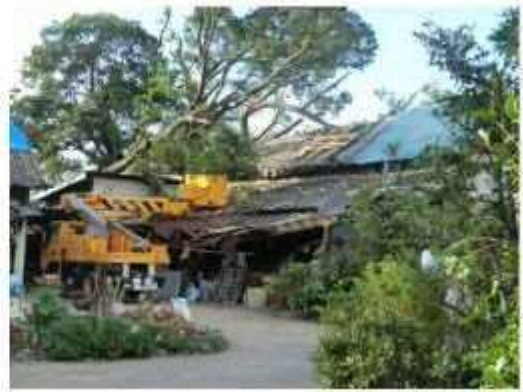
樹木の倒壊による小屋組の被害
