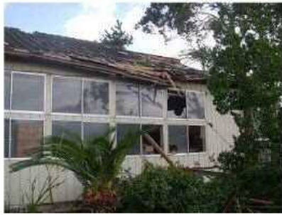
倉庫の窓ガラスと屋根の被害状況
