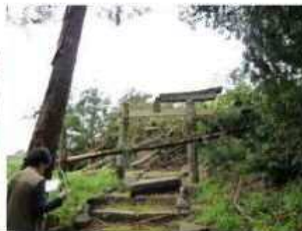
樹木の折損と鳥居の被害
