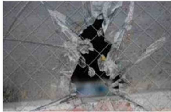
ガラスへの飛来物の衝突痕
