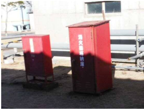
#152 消火設備格納箱
