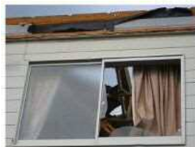
窓ガラスの損壊
