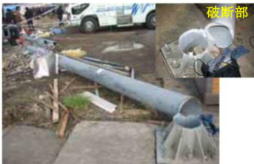
倒壊した道路標識支柱
