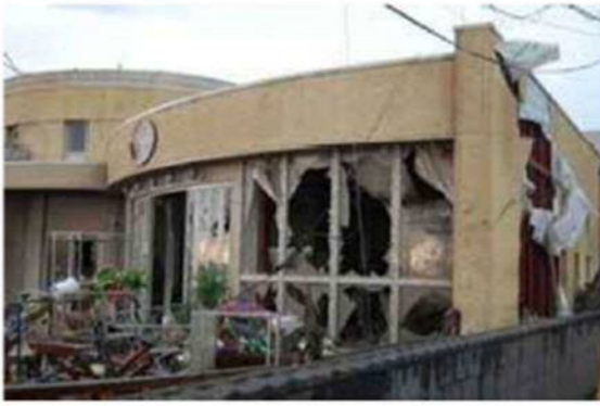
店舗の窓ガラスの被害状況
