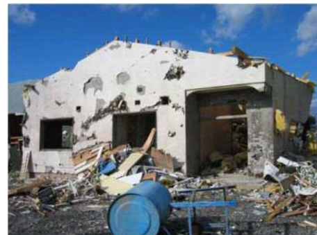
飛来物による被害を受けた建物
