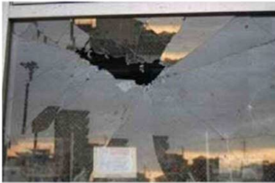
ガラスへの飛来物の衝突痕
