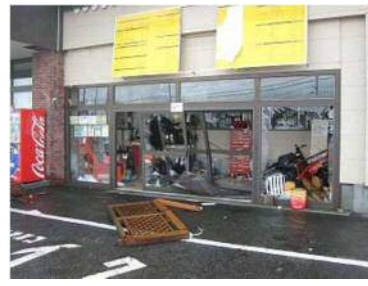
エントランスのガラス破損
