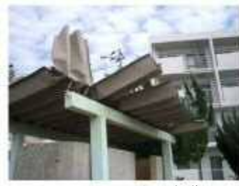
屋外トイレ屋根の損傷
