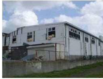
窓ガラスの破損
