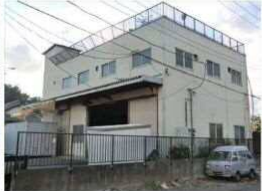
屋上フェンスの被害
