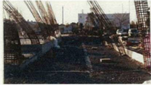
曲がった鉄筋 (工事現場)
