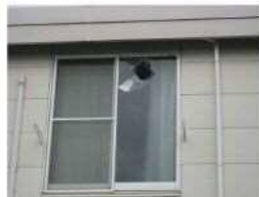
窓ガラスの飛来物衝突痕
