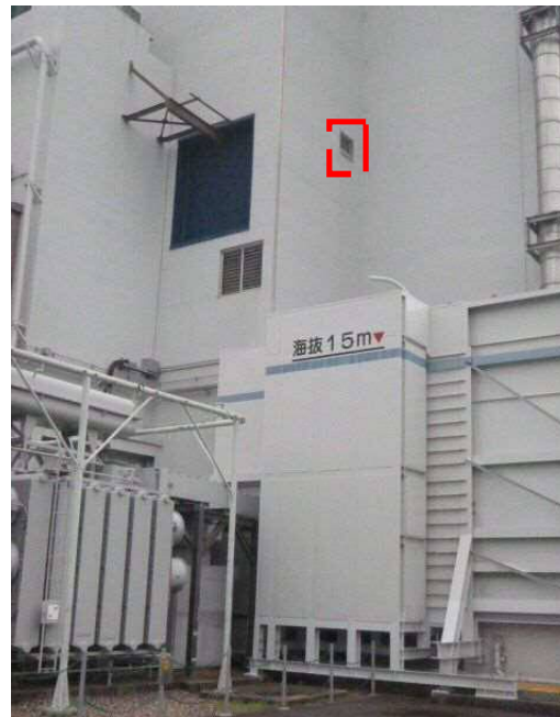
No. 13 中央制御室空調給気ルーバ (地上部より約 18m 側)
