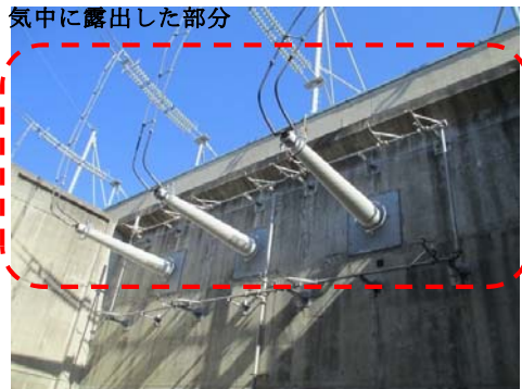
i) 275kV 送電線引込部
