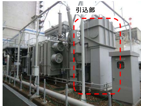
iv) 予備変圧器 (露出部無)
