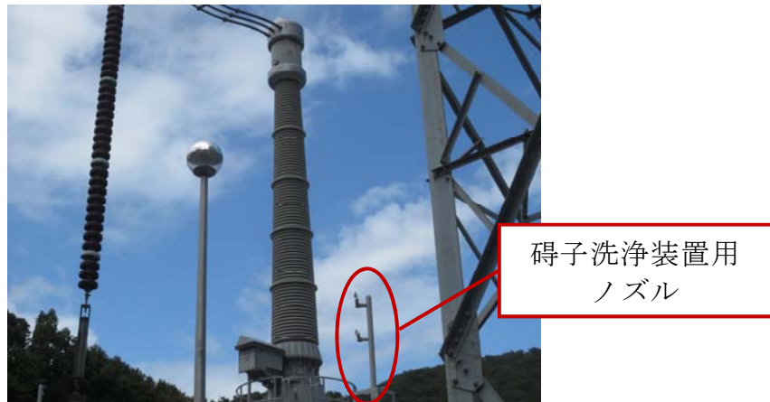
第 2.2.4.6-1 図 碍子洗浄装置外観 (例)
