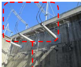
254kV 送電線引込部
