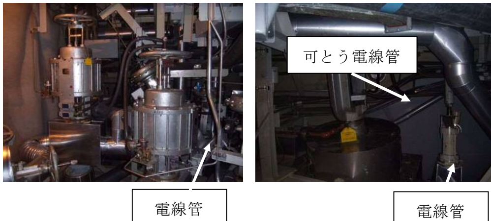
第 8-6 図 原子炉格納容器内の機器等の設置状況
