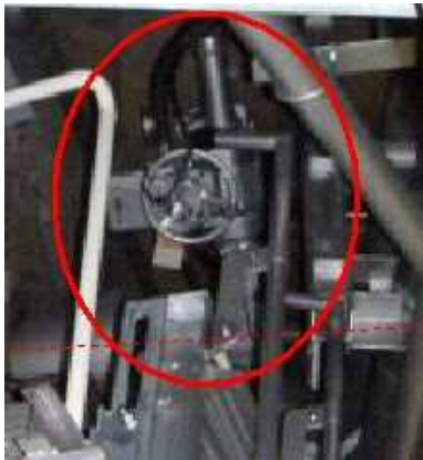
通路上部の電動弁，電線管他
