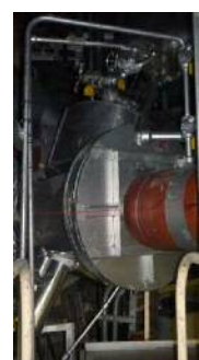
通路上部の電動弁
