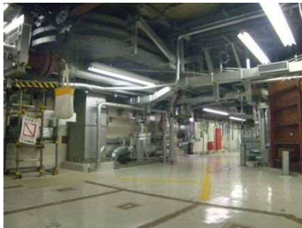
通路上の機器設置状況
