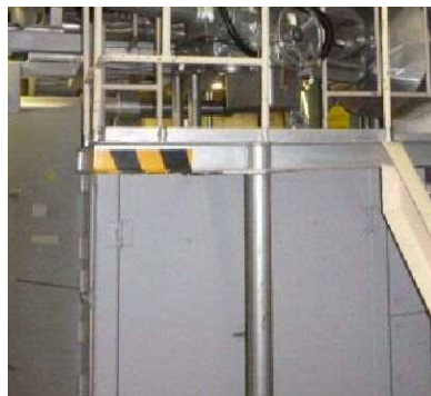
電動弁(遮蔽内に設置)
