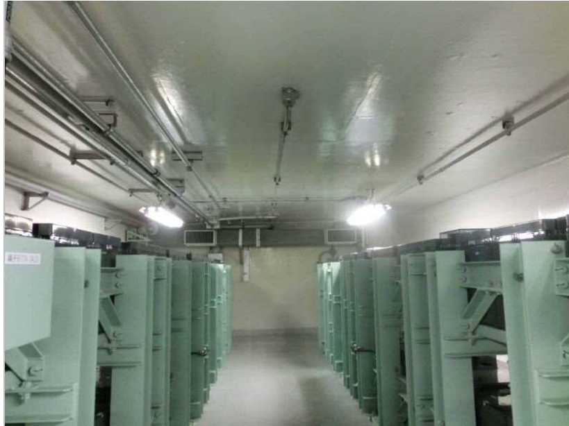
第 1-34 図 蓄電池の設置状況
