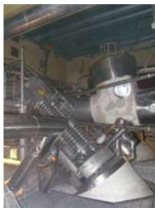
主蒸気隔離弁
