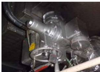
通路上部の電動弁
