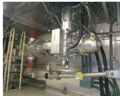
電動弁及び電線管他
