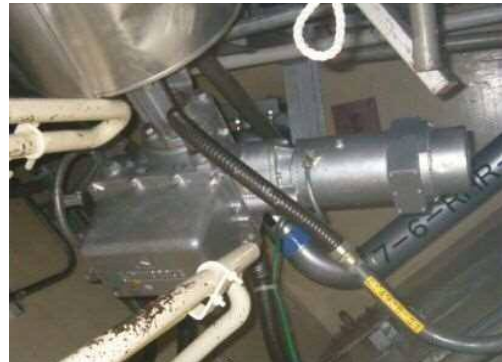
通路部上部の電動弁，電線管他
