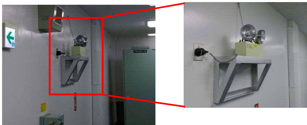
第2図 蓄電池内蔵型の照明
