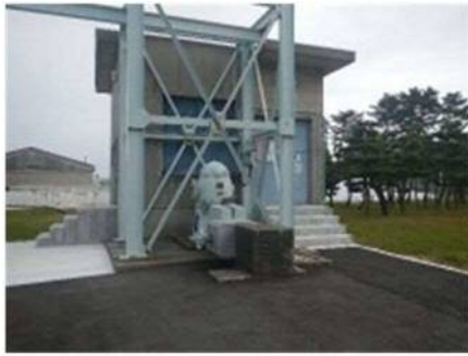
T/H 消火用ディーゼルポンプ室
