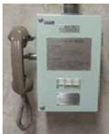
運転指令設備 (ページング)
