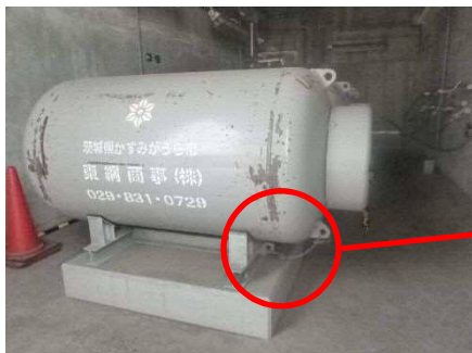
焼却炉用プロパンボンベ庫
