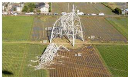
強風による鉄塔の倒壊事例① ※1
