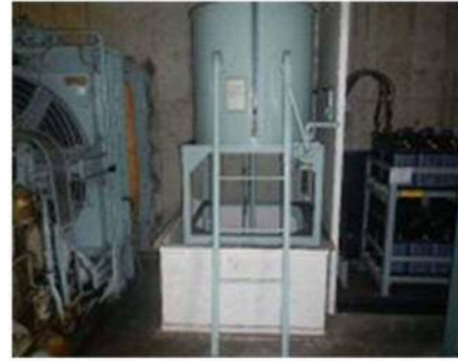
T/H 消火用ディーゼルポンプ室 T/H 消火用ディーゼルポンプ用タンク設置状況
