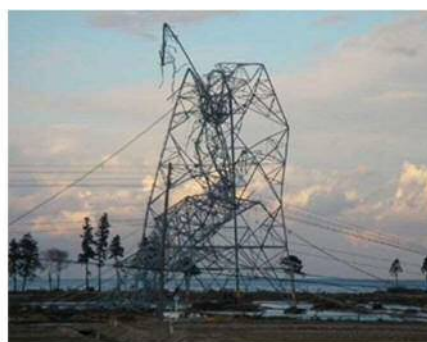
津波による隣接鉄塔の倒壊に伴う鉄塔の倒壊事例 ※2
