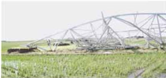
強風による鉄塔の倒壊事例 1
