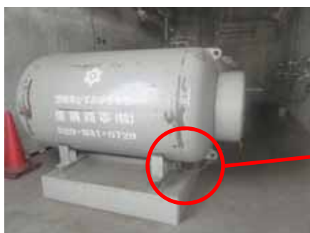
焼却炉用プロパンボンベ庫
