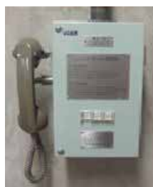
運転指令設備 ( ページング )
