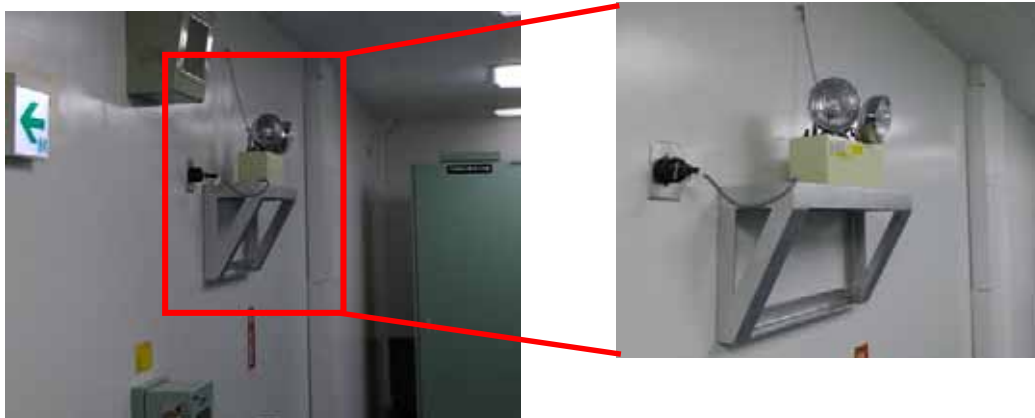
第2図 蓄電池内蔵型の照明
