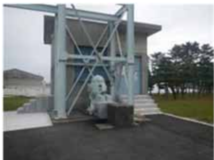
T/H 消火用ディーゼルポンプ室
