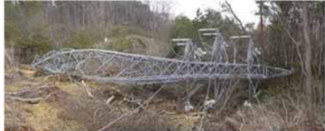
地震による斜面の崩落に伴う鉄塔の倒壊事例 2
