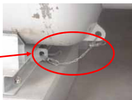
焼却炉用プロパンボンベ庫 プロパンボンベの固縛状況
