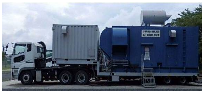
常設代替交流電源設備
