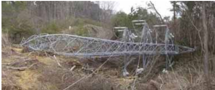
地震による斜面の崩落に伴う鉄塔の倒壊事例 2
