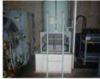
T/H 消火用ディーゼルポンプ室 T/H 消火用ディーゼルポンプ用タンク設置状況
