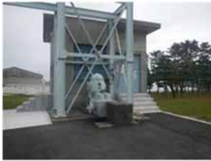
T/H 消火用ディーゼルポンプ室
