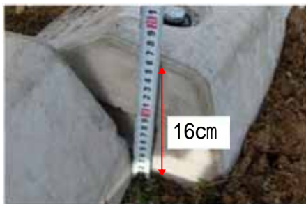
【段差復旧検証用段差】
