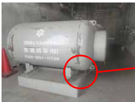
焼却炉用プロパンボンベ庫
