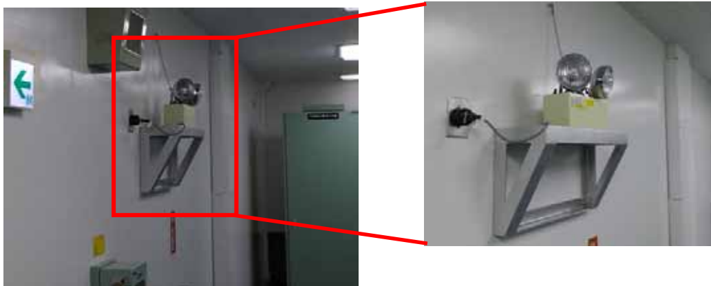
第2図 蓄電池内蔵型の照明
