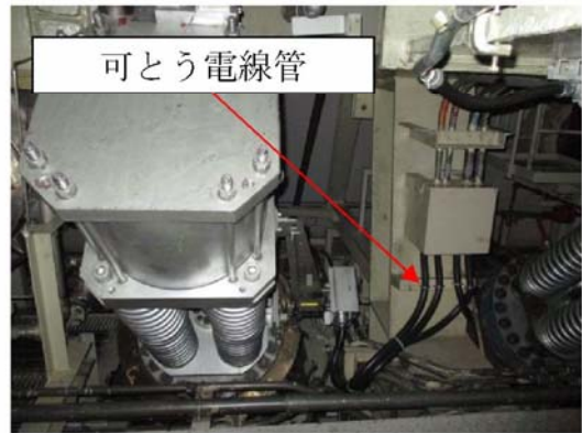
機器へのケーブル取合状況 (主蒸気内側隔離弁との取合)
