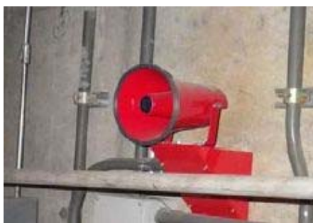
退避サイレン用音響装置
