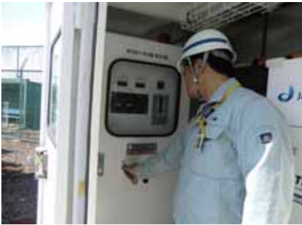
可搬型窒素供給装置（小型）起動
