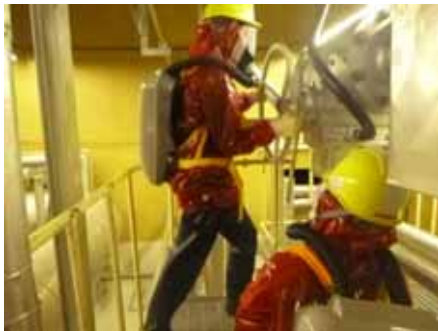
現場手動隔離操作 (放射線防護具装着)
