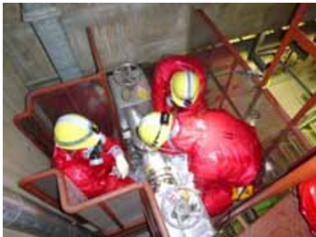
連絡配管閉止フランジ切替訓練
