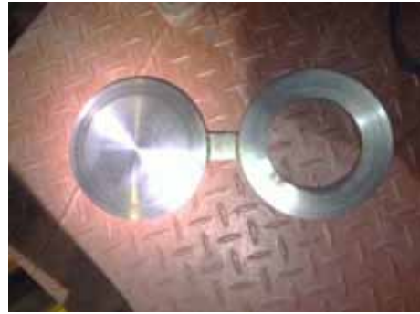
連絡配管閉止フランジ
