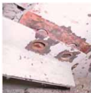
筋かい材ボルト破断
