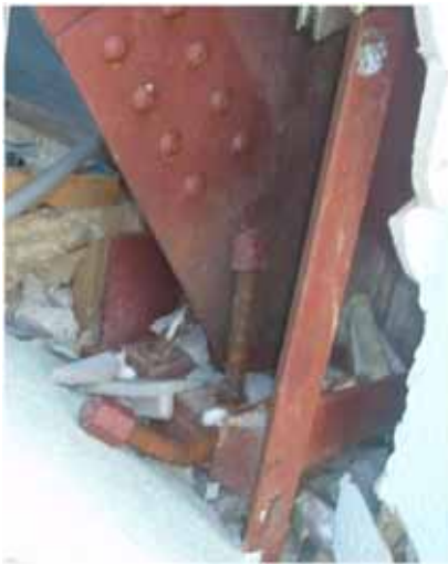
アンカーボルト引き抜け
