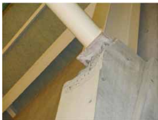
支承部コンクリート側方破断
