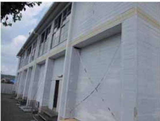
筋かい材の変形
