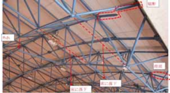
筋かい材の座屈・落下
