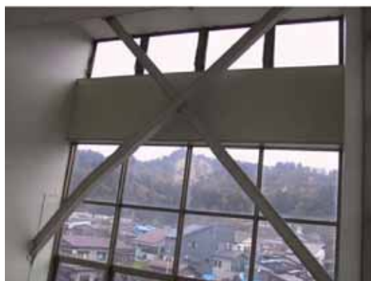
ブレース材の座屈
