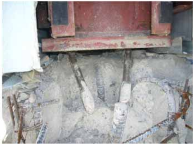
柱脚部コンクリート破断
