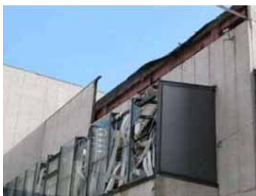
外装材の脱落，ガラス破損
