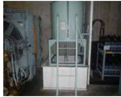
T/H 消火用ディーゼルポンプ室 T/H 消火用ディーゼルポンプ用タンク設置状況
