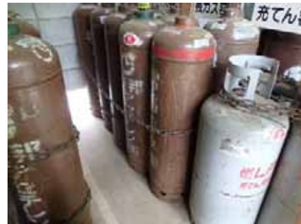
協力会社ボンベ小屋 アセチレン・プロパンボンベ設置状況
