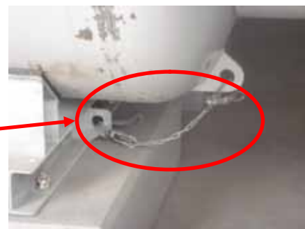
プロパンボンベ庫 プロパンボンベの固縛状況
