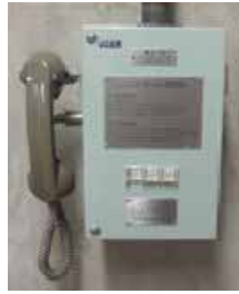
運転指令設備 (ページング)
