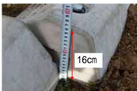
【段差復旧検証用段差】
