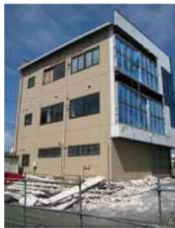
ALC パネルの脱落
