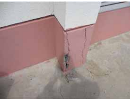
柱脚部コンクリートのひび割れ
