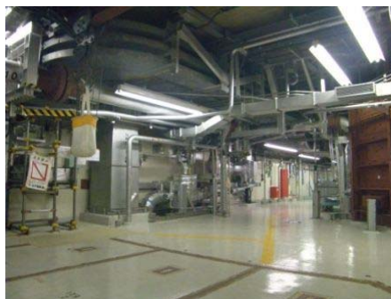
通路上の機器設置状況
