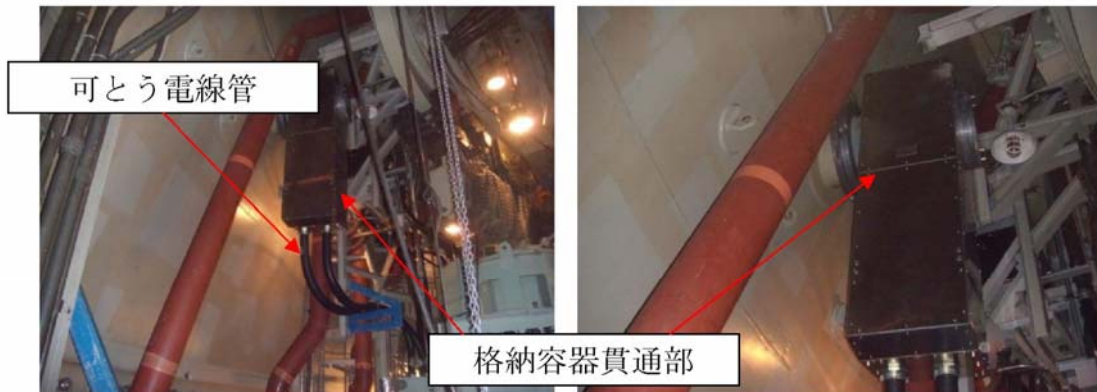
機器へのケーブル取合状況 (格納容器貫通部と電線管との取合)
