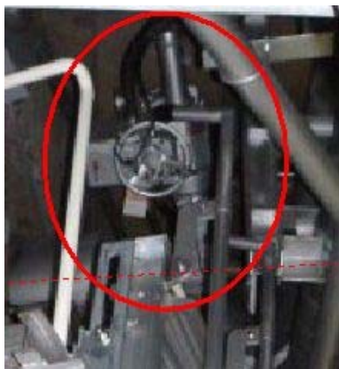
通路上部の電動弁，電線管他
