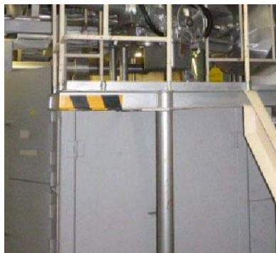
電動弁(遮蔽内に設置)
