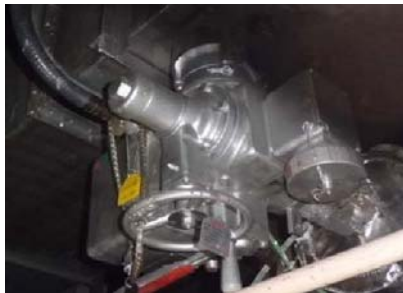
通路上部の電動弁
