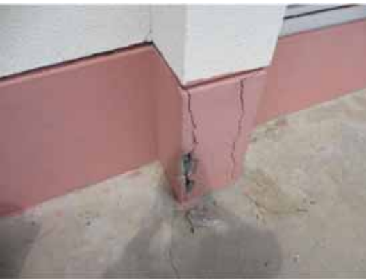
柱脚部コンクリートのひび割れ
