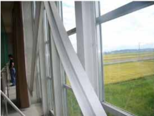
筋かい材の座屈（刈羽村）
