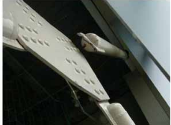
筋かい材プレート破断
