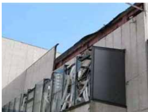
外装材の脱落, ガラス破損
