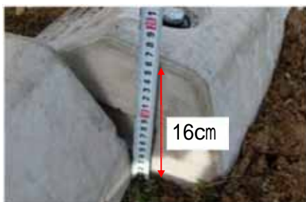
【段差復旧検証用段差】
