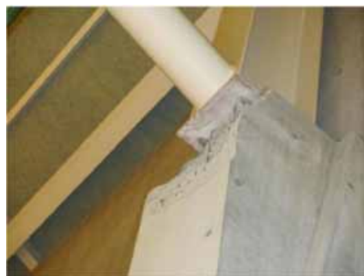
支承部コンクリート側方破壊
