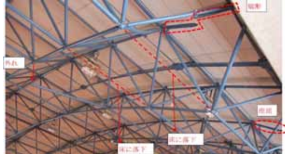
筋かい材の座屈・落下
