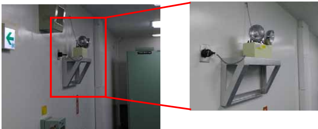
第2図 蓄電池内蔵型の照明
