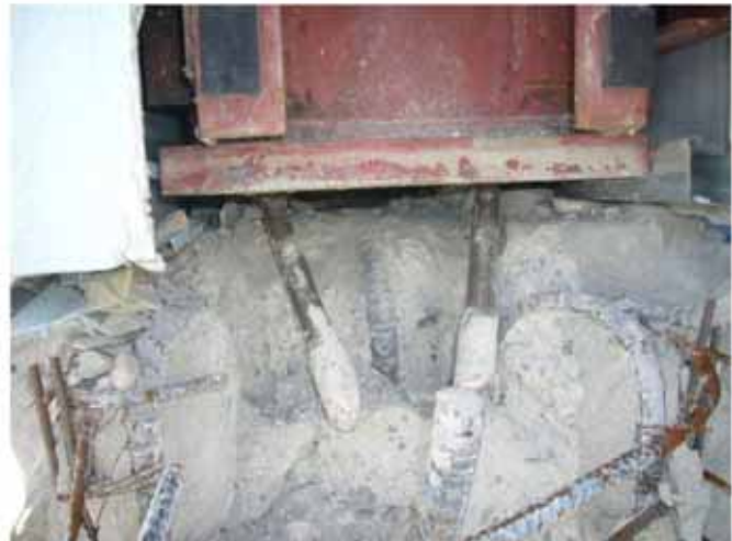
柱脚部コンクリート破壊
