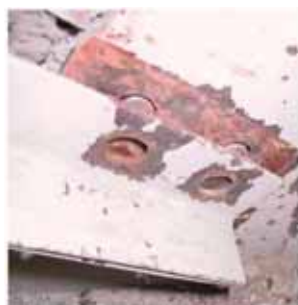
筋かい材ボルト破断
