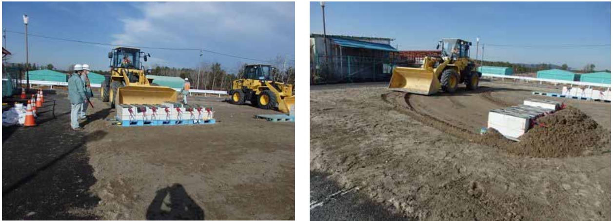
第 6 図 がれき撤去検証の写真
