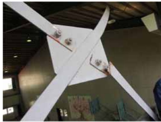
ブレース孔欠損部の破断
