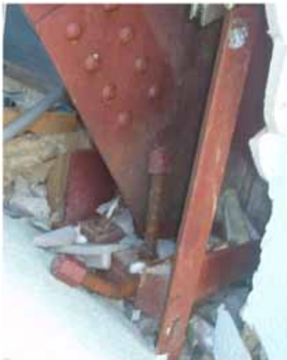
アンカーボルト引き抜け
