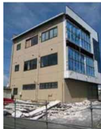
ALC パネルの脱落
