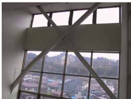
ブレース材の座屈
