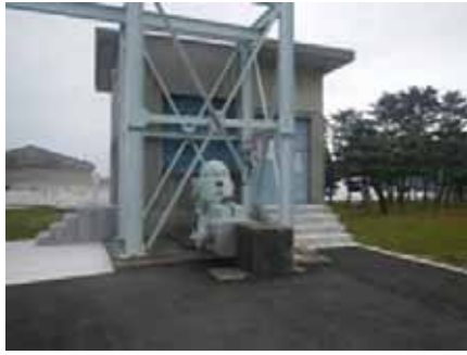
T/H 消火用ディーゼルポンプ室
