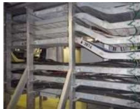
【ケーブル処理室の多段トレイ】
