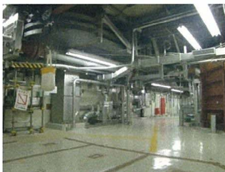
通路上の機器設置状況
