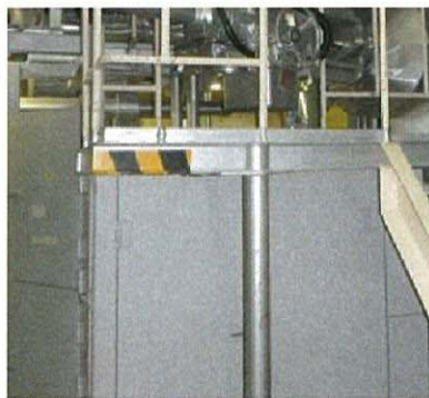
電動弁 (遮蔽内に設置)
