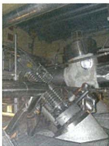
主蒸気隔離弁
