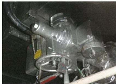
通路上部の電動弁
