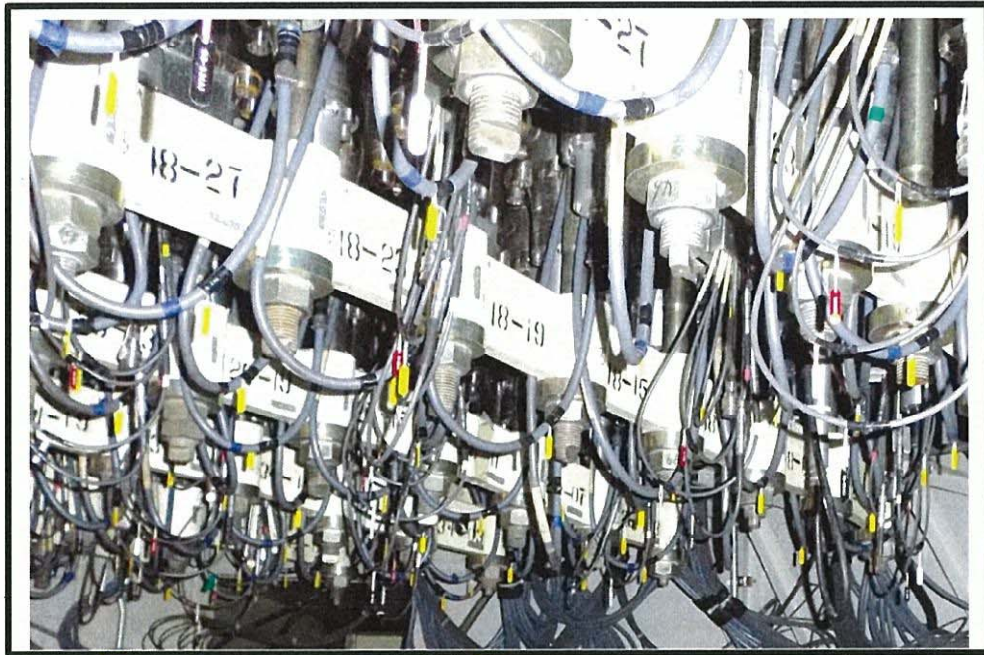
第 8-7 図 原子炉圧力容器下部の核計装ケーブルの一部露出状況
