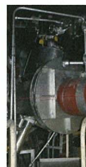
通路上部の電動弁
