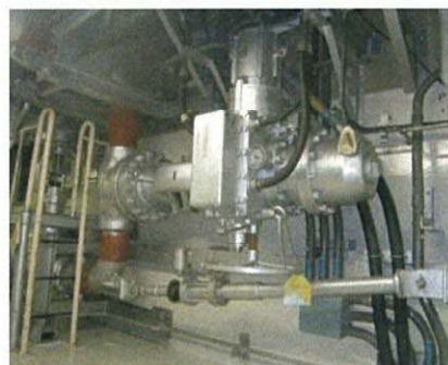
電動弁及び電線管他
