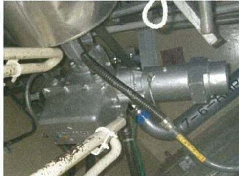
通路部上部の電動弁，電線管他
