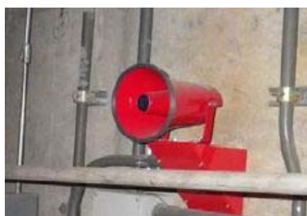
退避サイレン用音響装置
