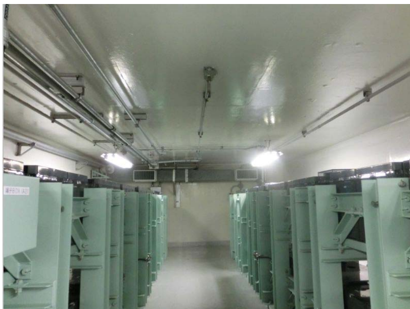
第 1-42 図 蓄電池の設置状況
