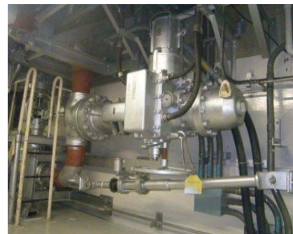
電動弁及び電線管他
