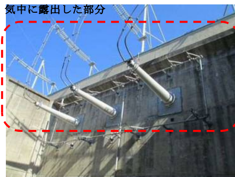
i) 275kV 送電線引込部
