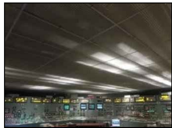
（直流非常灯点灯状態）
