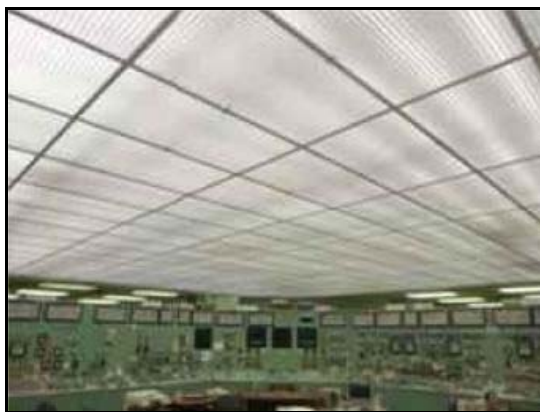
（通常点灯状態）
