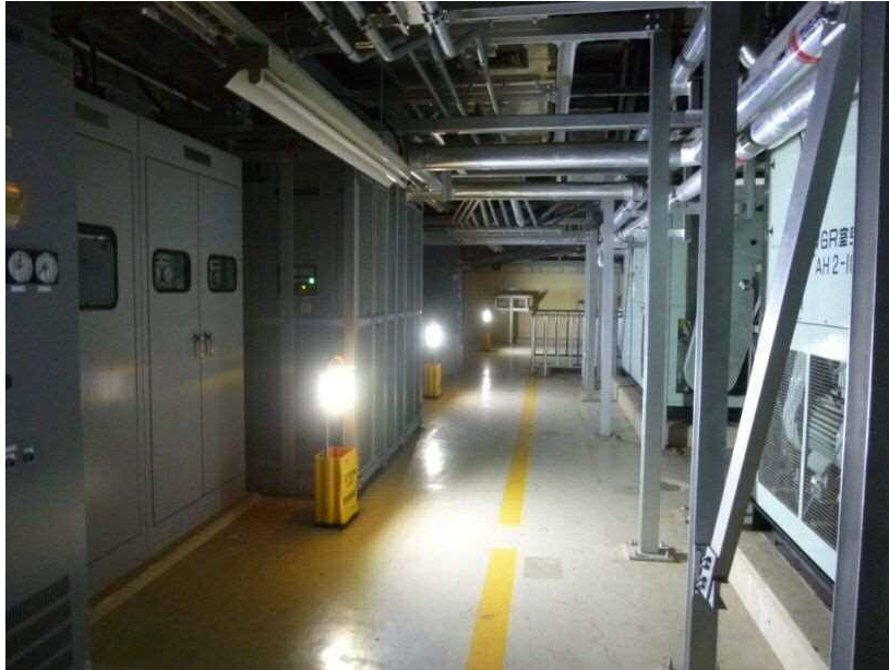
第9図 チェンジングエリア設置場所における 可搬型照明（S A）確認状況
