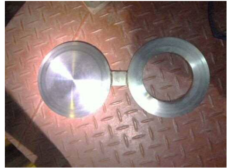
連絡配管閉止フランジ
