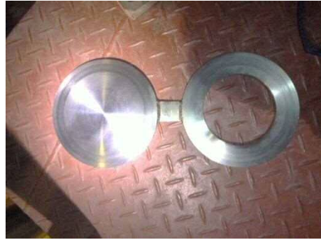
連絡配管閉止フランジ
