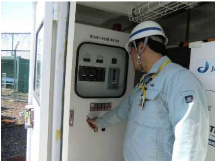
可搬型窒素供給装置 (小型) 起動
