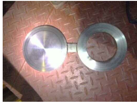
連絡配管閉止フランジ
