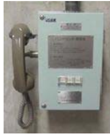
運転指令設備 (ページング)
