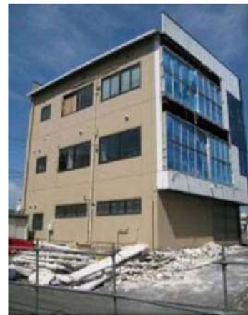
ALC パネルの脱落
