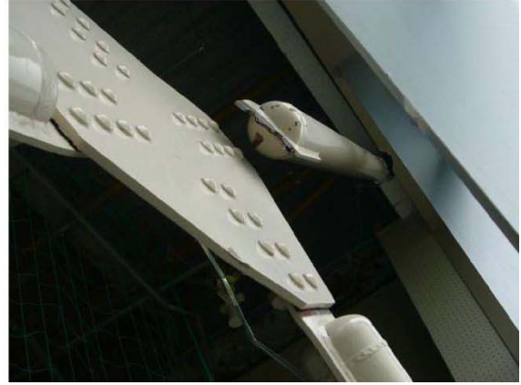
筋かい材プレート破断
