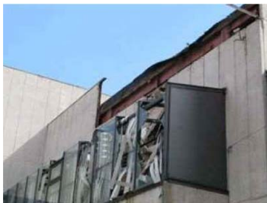
外装材の脱落，ガラス破損
