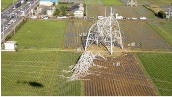
強風による鉄塔の倒壊事例①※ 1
