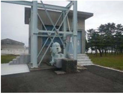
T/H 消火用ディーゼルポンプ室
