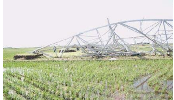
強風による鉄塔の倒壊事例②※ 1
