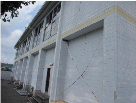
筋かい材の変形
