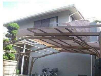
カーポートの被害
