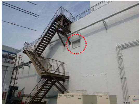
図2 外気取入口（中央制御室換気空調系）
