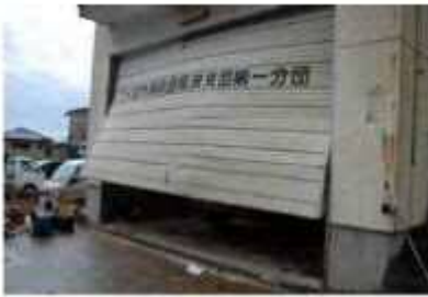
消防団施設のシャッターの被害状況
