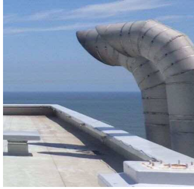
図3 ディーゼル発電機 排気管
