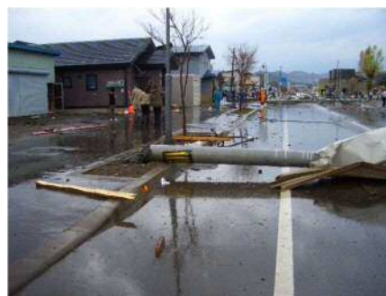
道路側へ倒壊した電柱
