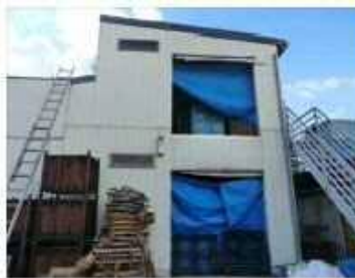
シャッターの被害
