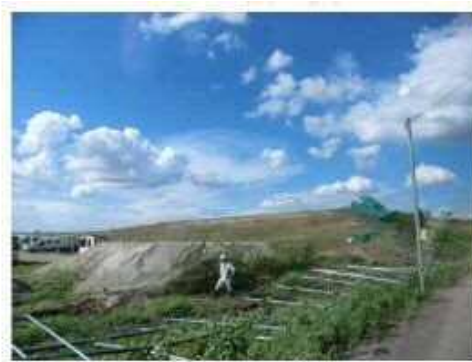
フェンスの被害
