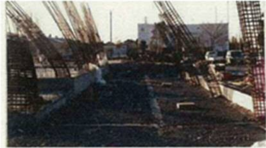
曲がった鉄筋（工事現場）
