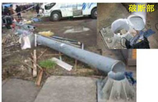
倒壊した道路標識支柱
