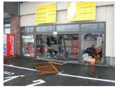
エントランスのガラス破損
