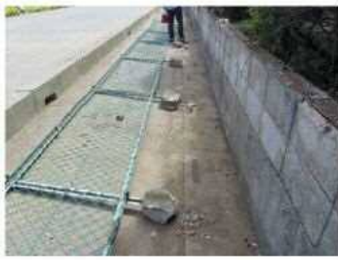
フェンスの倒壊
