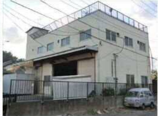
屋上フェンスの被害
