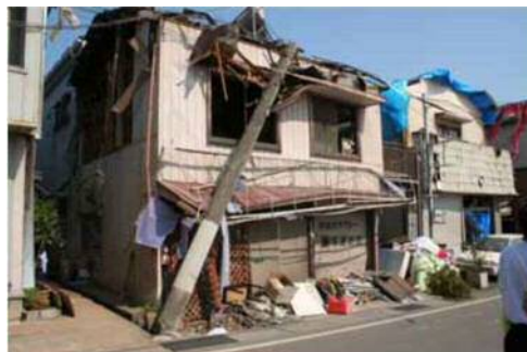
倒壊電柱に直撃された家屋
