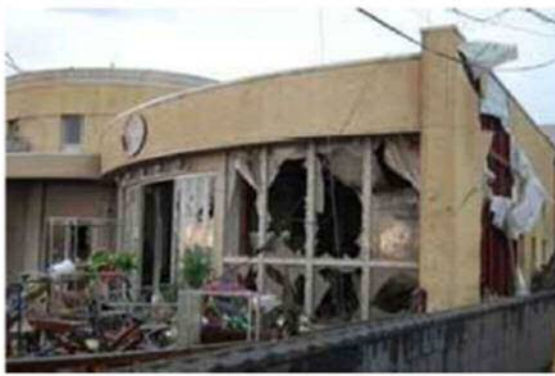
店舗の窓ガラスの被害状況
