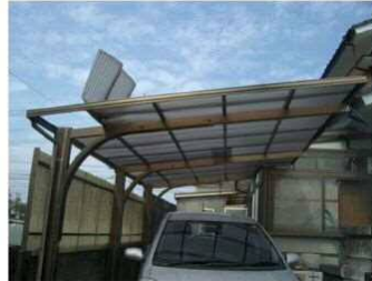
カーポート屋根の破損
