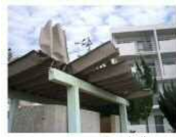
屋外トイレ屋根の損傷
