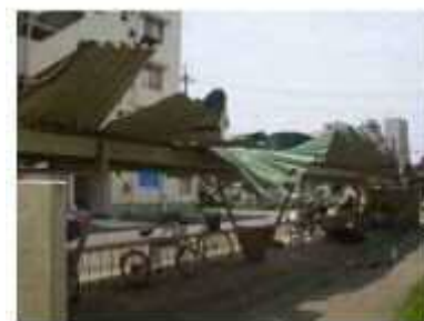
駐車場の折板屋根の著しい変形
