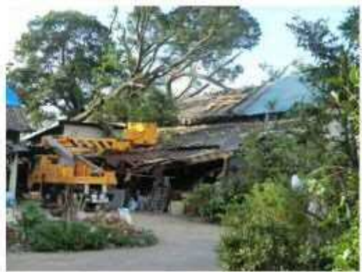
樹木の倒壊による小屋組の被害
