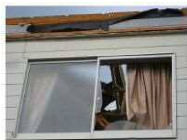
窓ガラスの損壊
