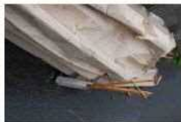
飛散した折板屋根の状況
