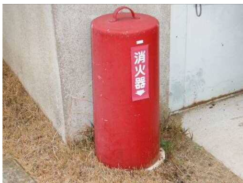
#33 消火設備格納箱
