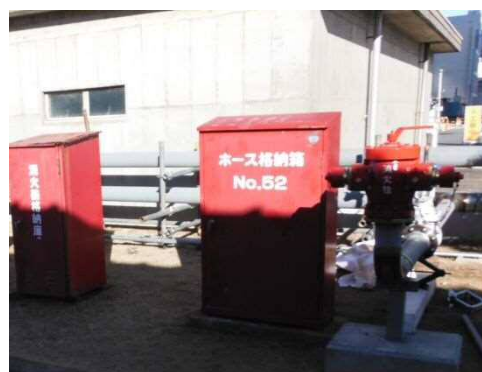
#153 消火設備格納箱
