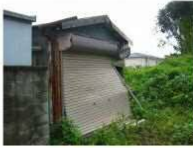
シャッターの外れ
