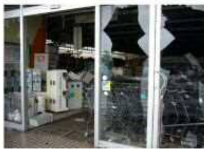
エントランスの窓ガラスの破損
