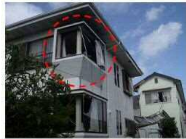
出窓部の窓ガラスの被害
