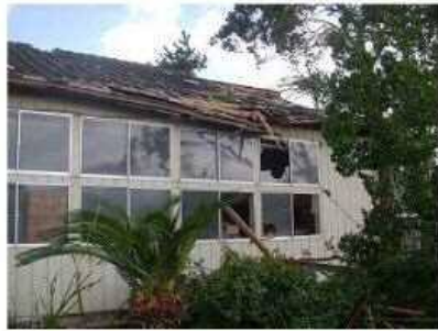
倉庫の窓ガラスと屋根の被害状況
