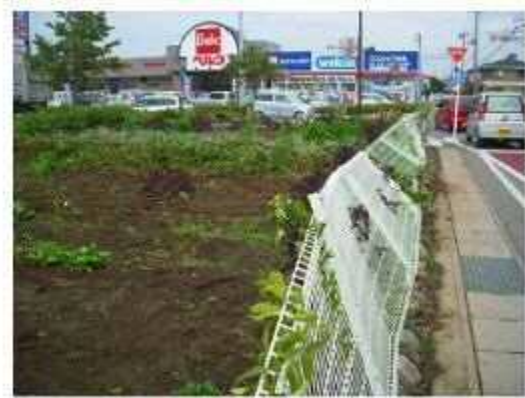
フェンスの変形
