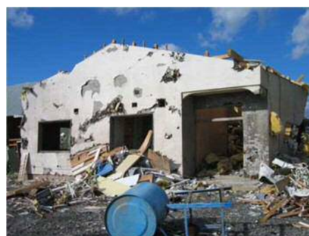
飛来物による被害を受けた建物
