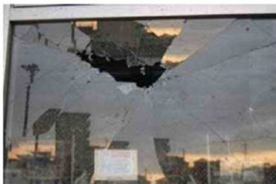
ガラスへの飛来物の衝突痕
