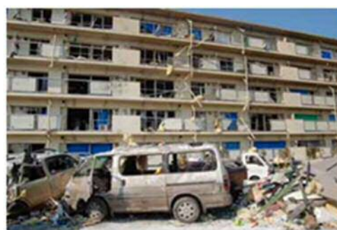
飛来物により被害を受けた住宅等
