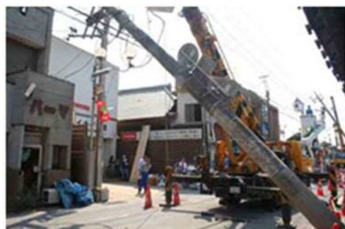
倒れた電柱(復旧作業時)
