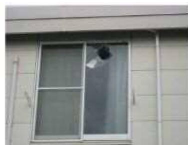
窓ガラスの飛来物衝突痕
