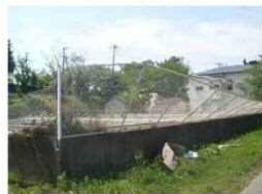
フェンスの被害状況
