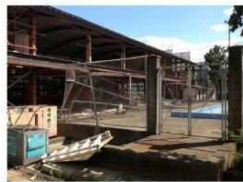
フェンスの被害（工事中の建築物）
