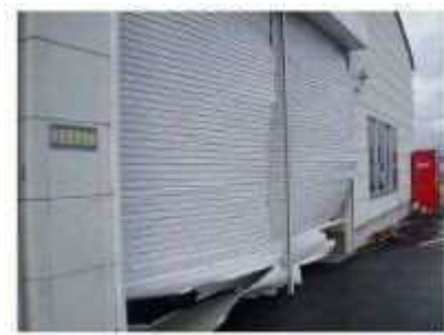
シャッターの破損
