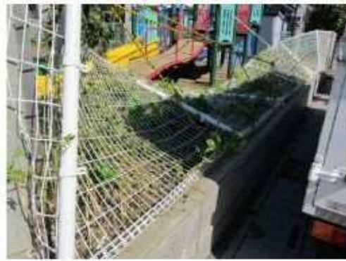
フェンスの倒壊
