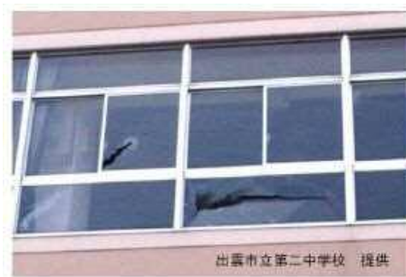
体育館窓ガラスの破損
