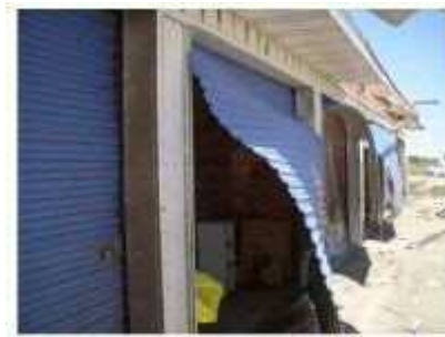
シャッターの外れ
