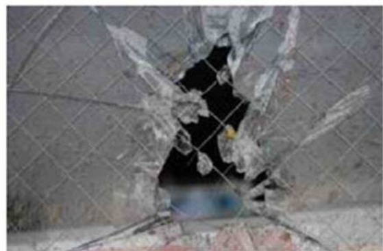
ガラスへの飛来物の衝突痕
