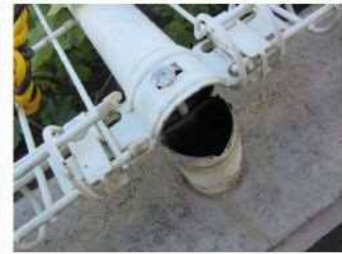
支柱部の破断
