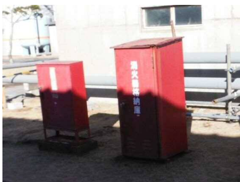
#152 消火設備格納箱
