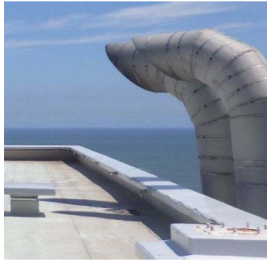
図5 ディーゼル発電機 排気管
