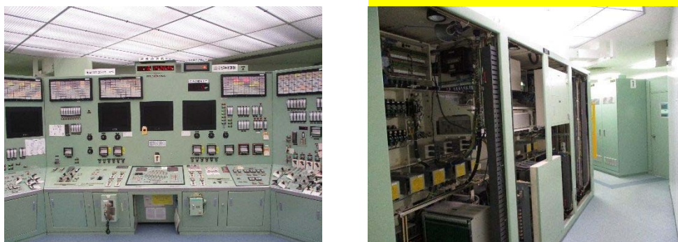
図3 原子炉制御盤 (換気口無し)
