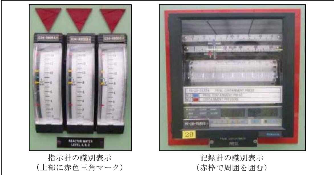
第 2.4.1-6 図 重要指示計等の識別表示 (例)
