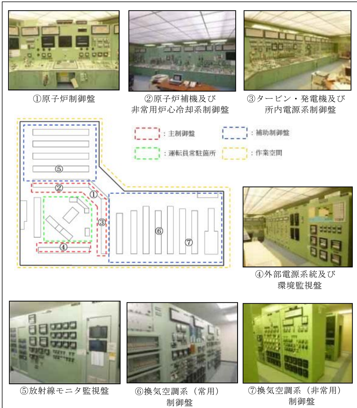
第 2.4.1-1 図 中央制御室の制御盤配置
