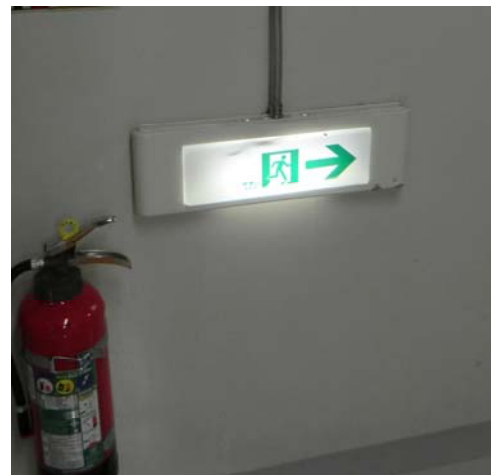
通路誘導灯（廊下・通路）
