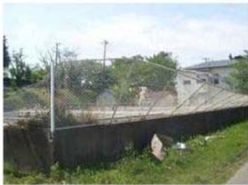
フェンスの変形
