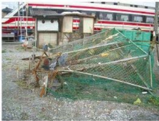
フェンスの著しい変形
