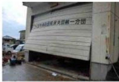
消防団施設のシャッターの 変形
