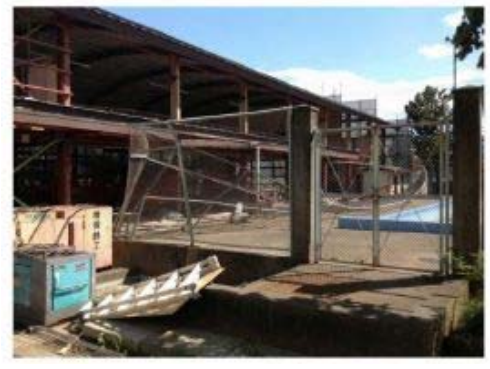
フェンスの 変形 (工事中の建築物)
