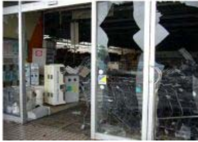
エントランスの窓ガラスの損壊
