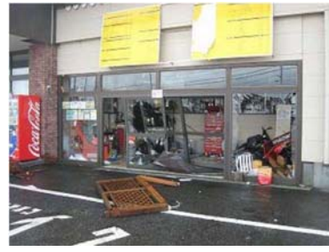
エントランスのガラス損壊
