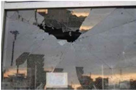
ガラスの被害状況（飛来物衝突痕）
