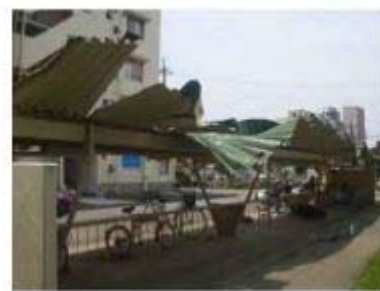
駐車場の折板屋根の著しい変形
