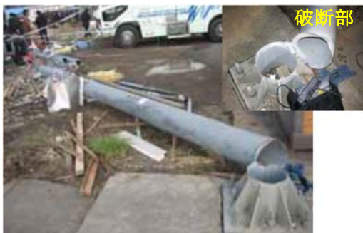
倒壊した道路標識支柱
