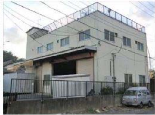
屋上フェンスの 変形
