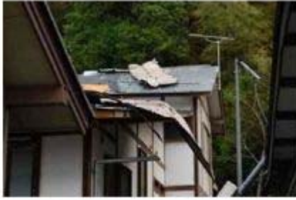
飛来物（鋼板製屋根材）の衝突
