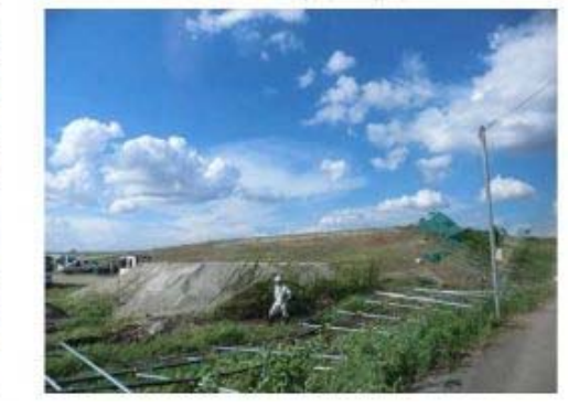
フェンスの 倒壊
