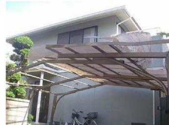
カーポートの被害
