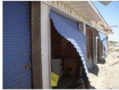
シャッターの外れ
