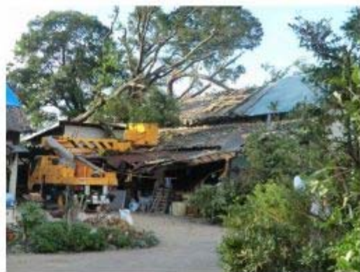
樹木の倒壊による小屋組の被害
