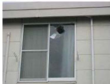
窓ガラスの飛来物衝突痕
