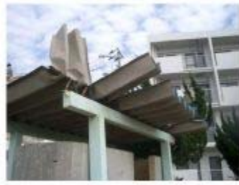
屋外トイレ屋根の損傷
