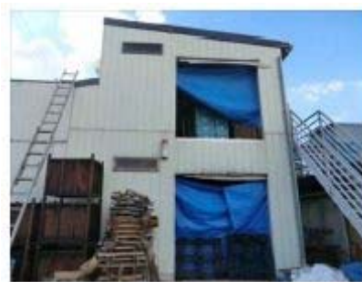
シャッターの 外れ
