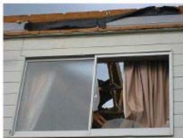
窓ガラスの損壊
