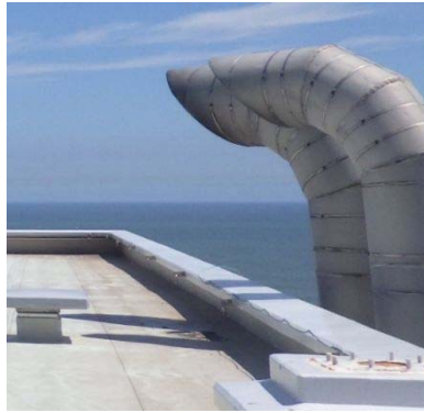
図5 ディーゼル発電機 排気管
