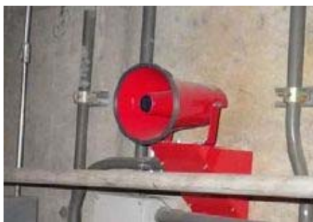
退避サイレン用音響装置
