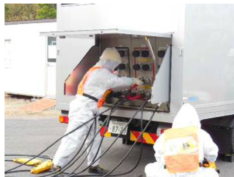
移動式高圧電源車の訓練の状況 （写真は過酷環境を想定した服装による、電源ケーブルを接続作業）
