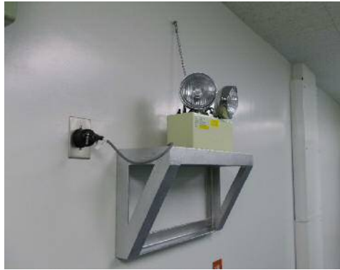
第 1.0.13-6 図 蓄電池内蔵型照明の例
